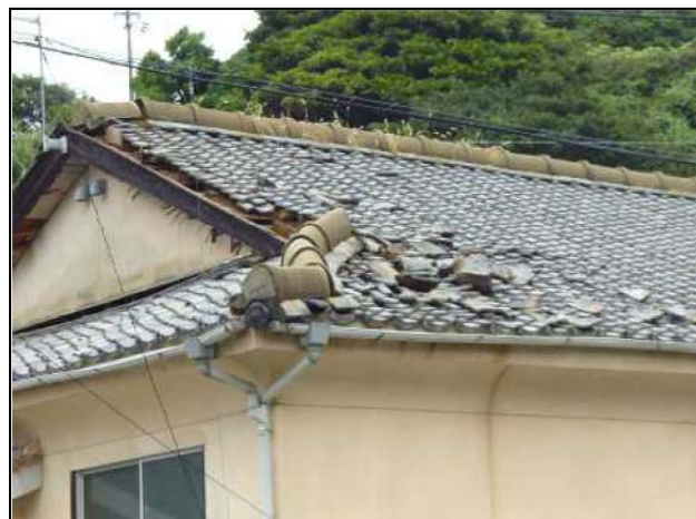
①住家屋根瓦の捲れ(撮影方向:北西) 写真提供:平戸市役所大島支所
