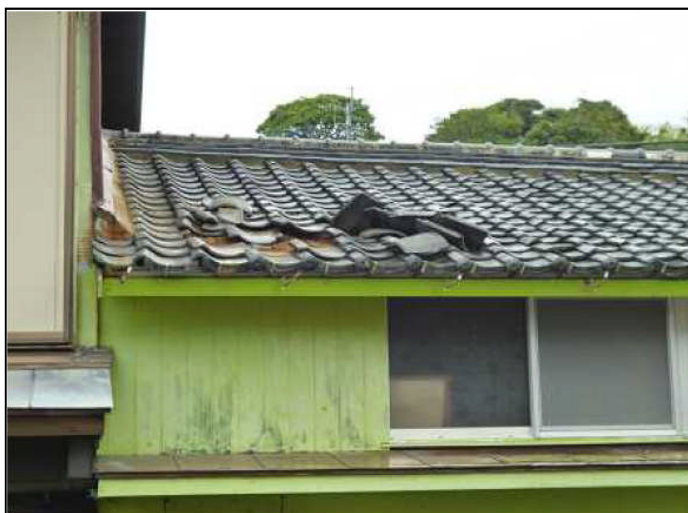
①住家屋根瓦の捲れ(撮影方向:北西) 写真提供:平戸市役所大島支所
