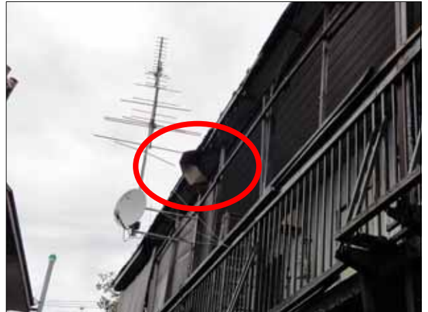
屋根が剥離したアパート (南西から撮影)
