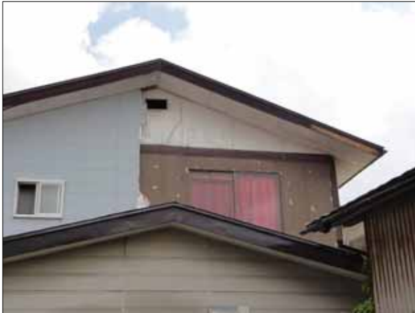
外壁の一部が剥離した住家 (西から撮影)
