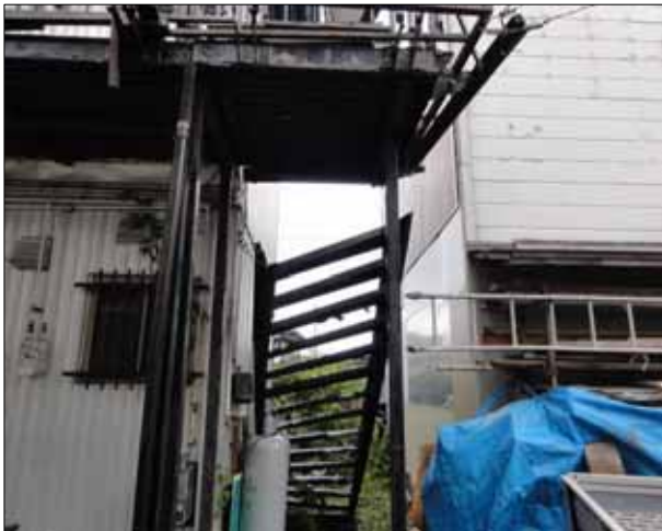
階段が落下したアパート (西から撮影)
