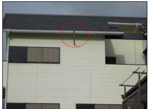
図 4-10-1 撮影場所 -1 土佐清水市役所提供 3 階東側の外壁(モルタル)に木材が突き刺さっている。
