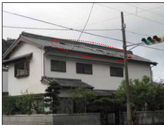
図 4-4 撮影場所 土佐清水市役所提供 北面屋根瓦が捲れている。
