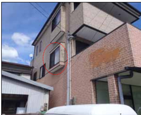
図 4-12 撮影場所 2 階西側の出窓ガラスが破損した（修復済み）。
