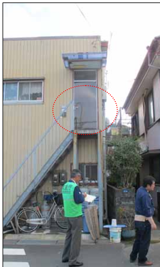
図 4-13 撮影場所 北側階段の手すりの一部が西方向約 30m に飛散した。
