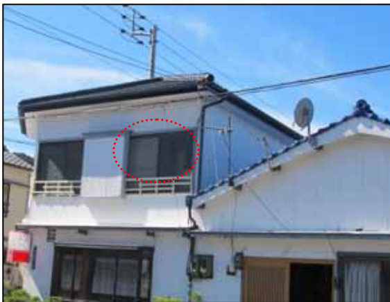
図 4-9 撮影場所 2 階東側の窓ガラスが飛散物により破損した(修復済み)。
