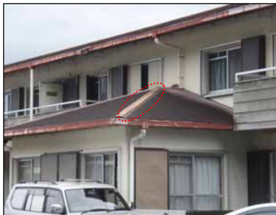
図 4-2 撮影場所 土佐清水市役所提供 屋根のトタンがはがれ、東方向に飛散した。
