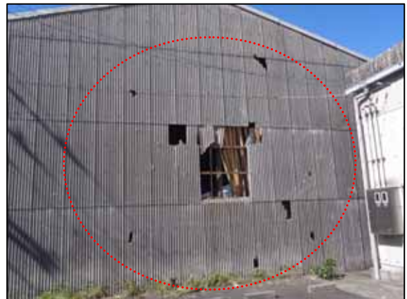
図 4-8 撮影場所 倉庫内の木材が東側の壁を突き抜ける(西側に常時開放口がある)。外からの飛散物でも壁に穴が開く。
