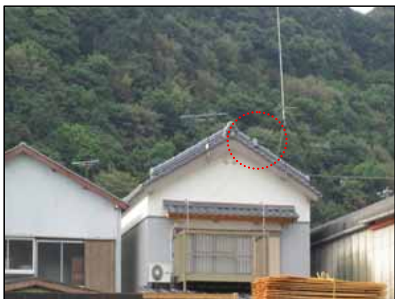
図 4-3 撮影場所 土佐清水市役所提供 西面屋根瓦が捲れている。
