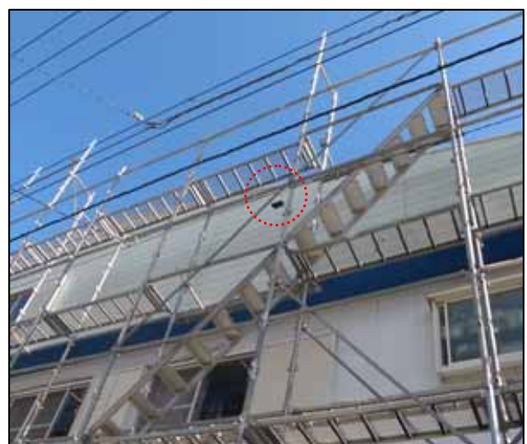
図 4-11 撮影場所 3 階西側の外壁に穴が空いている。(足場は 23 日に設置)
