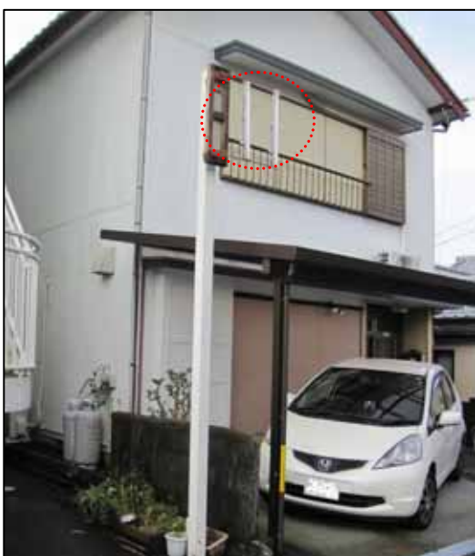
図 4-10-2 撮影場所 -2 土佐清水市役所提供 看板は壊れ、その鉄枠が西方向に曲がっている。
