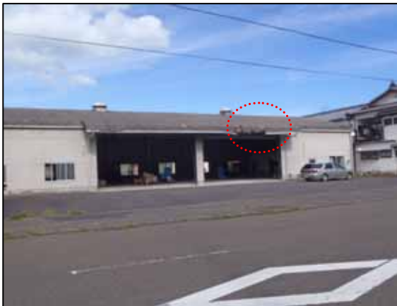
図 4-7 撮影場所 南面屋根及び雨どいに木材が当たり、一部破損している。
