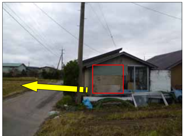
物置小屋のガラス窓が北西方向へ 約 15m 先の水田に飛ばされた (南西から撮影)
