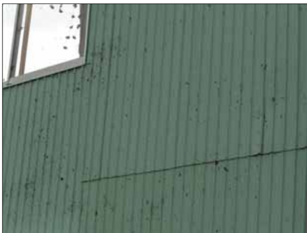
作業小屋の南壁面に付着した泥 (南東から撮影)
