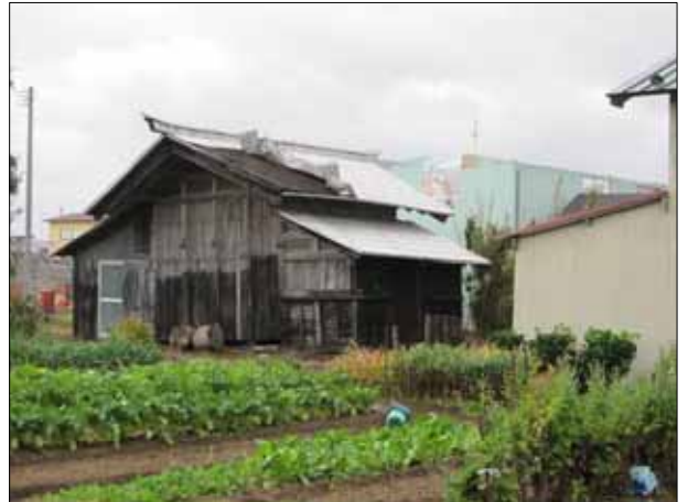
北東側に捲れ上がった物置小屋のトタン 屋根 (南西から撮影)
