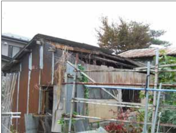
南面の屋根半分が飛散した物置小屋 (南西から撮影)
