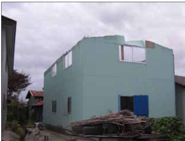
屋根が飛散した作業小屋 (西北西から撮影)
