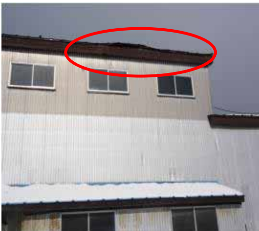
北側に捲れ上がったトタン屋根 (南から撮影)
