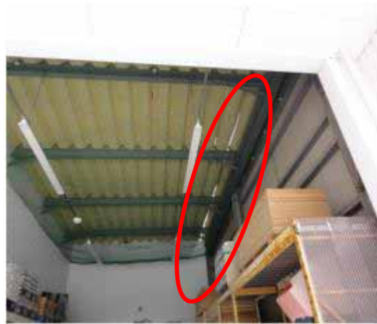
屋根が破損した店舗 (西から撮影)
