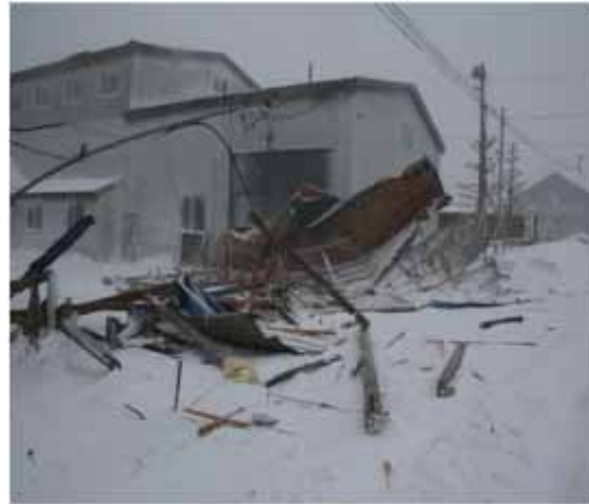
北東方向に飛散したトタン屋根 (西村土建株式会社提供：南東から撮影)
