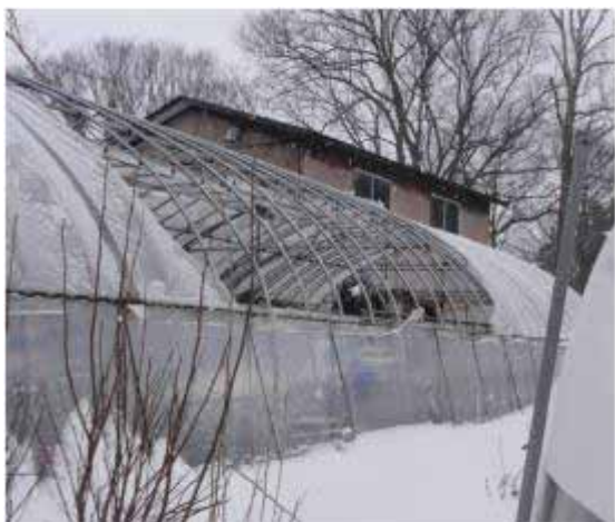
破損したビニールハウス (西から撮影)
