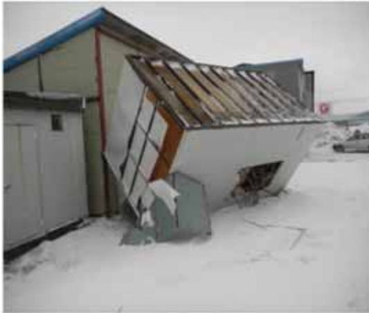
北東方向に飛ばされたプレハブ小屋 (八峰消防署提供：西から撮影)
