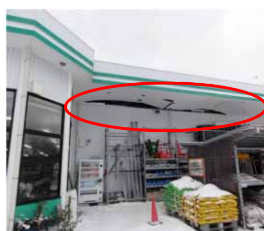
軒下大平板が破損した店舗 (西から撮影)
