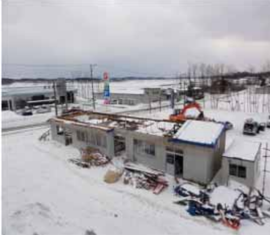
トタン屋根が飛散した事務所 (北西から撮影)
