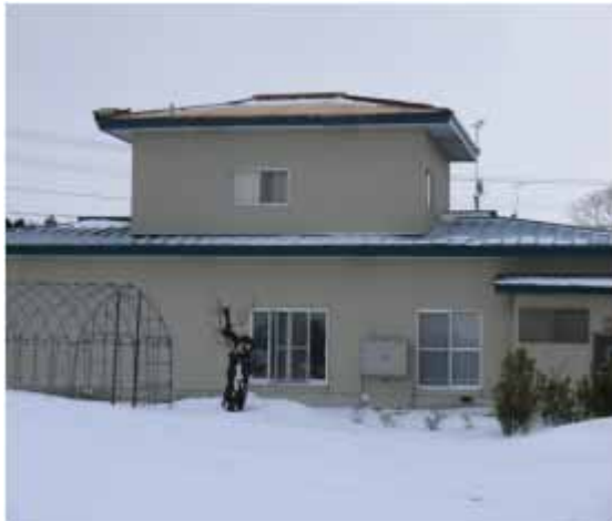
屋根のトタンが飛散した住家 (北から撮影)
