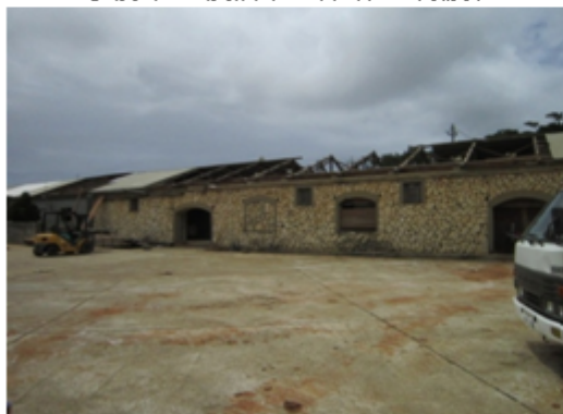
③非住家のトタン屋根の飛散（北から撮影）
