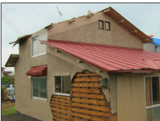
C 5 トタン屋根および外壁が剥離し飛 散した住家 （西から撮影）
