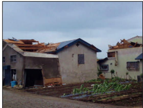
C 2 トタン屋根が剥離し飛散した 住家（右）および非住家（左） （西から撮影）
