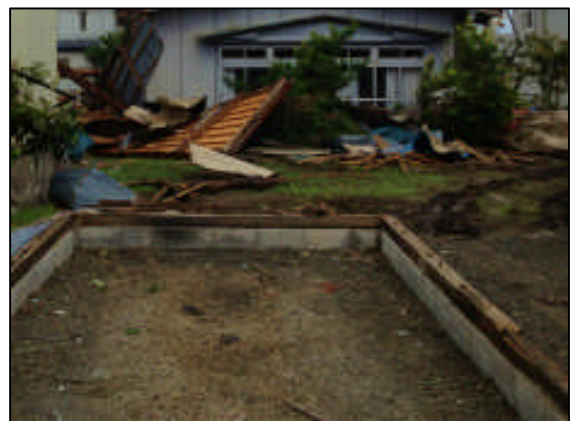
C 4 全壊し飛散した車庫（基礎のみ残る） （南西から撮影）
