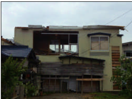
C 3 壁と窓が損壊、トタン屋根が剥離 し飛散した住家 （南西から撮影）
