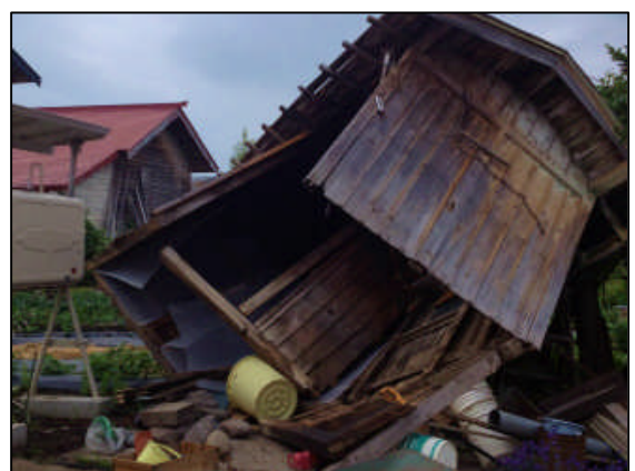
C 6 倒壊した小屋 （南東から撮影）
