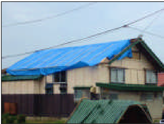
C 1 トタン屋根が剥離し飛散した住家 （西へ20m飛散） （西から撮影）
