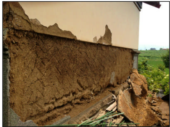
A 2 蔵の南西側壁面剥離 （西から撮影）
