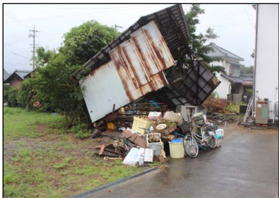
図 4-1 撮影場所① 北側に倒壊した倉庫
