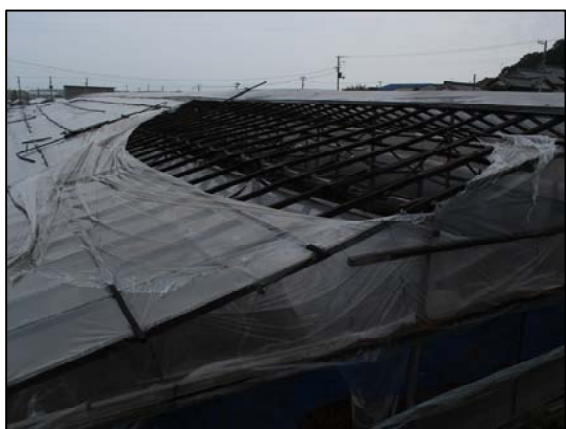
図 4-5 撮影場所⑤ ビニールの一部が捲れたビニールハウス
