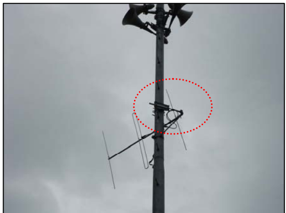
図 4-4 撮影場所④ 芸西村役場提供 南東方向に設置していたアンテナが、北東方向に折れ曲がっている。
