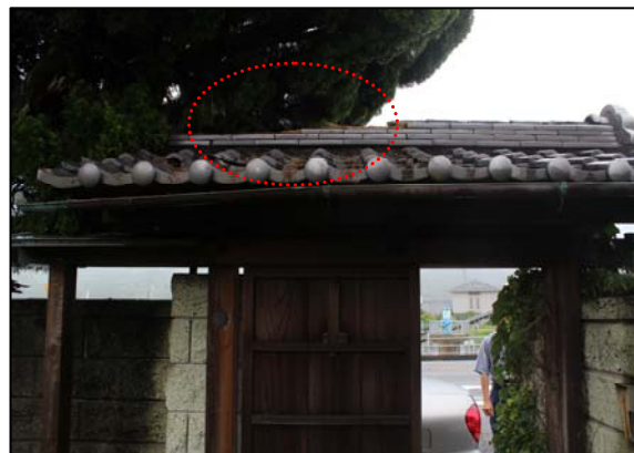
図 4-2 撮影場所② 門の屋根瓦の一部が飛散した。
