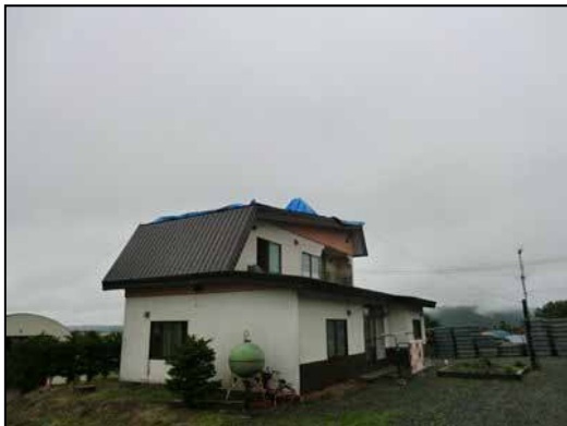
写真 -5- (地点5、北東方向を撮影) 屋根板が一部剥離し、東方向へ飛散し た住家。
