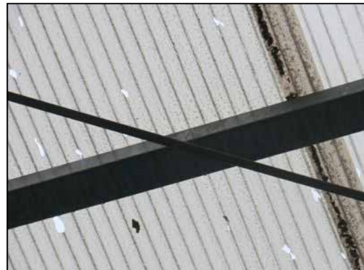
写真 -3- (地点3) 壁面がひょうにより多数の穴が開いたポリカーボネート製波板の屋根。小学校プールの屋根を屋内側から撮影。
