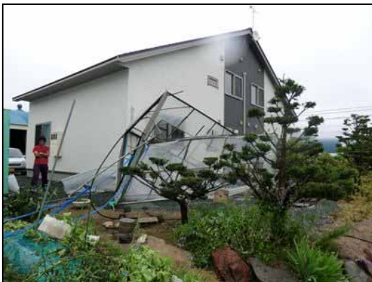
写真 -2- (地点2、北東方向を撮影) 住宅横の横転した温室。移動距離は最短部分で2m。温室のサッシ窓1枚が東南東に15m飛散。
