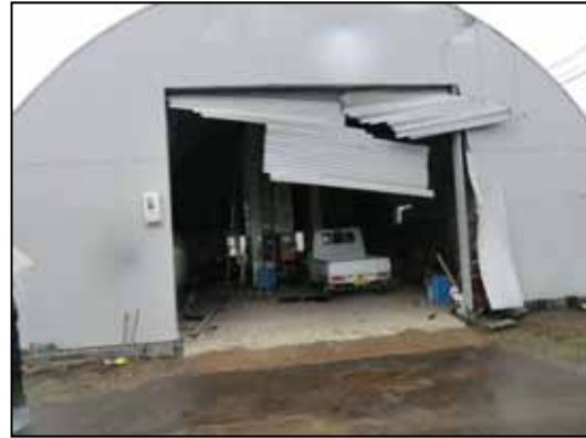
写真 -1- (地点1、北北東方向を撮影) 写真1- から東南東方向に64m離れた場所にありシャッター等が破損(被災当時は閉じていた)したD型倉庫。破損物は東南東方向へ75m飛散。
