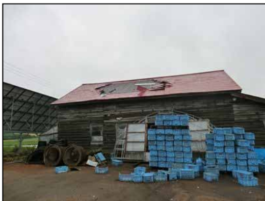
写真 -6- (地点6、西方向を撮影) トタン屋根が一部剥離し、東方向へ最 大29m飛散した木造倉庫。
