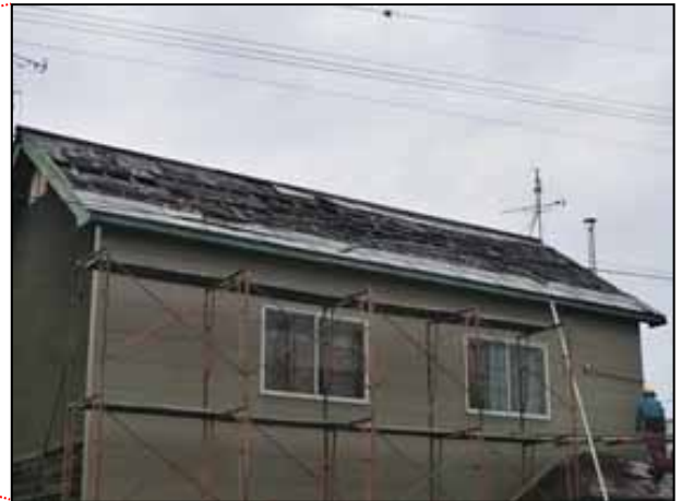
屋根のトタンが剥離した住家（屋根部分）
