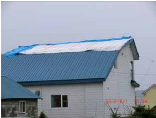
屋根のトタンが剥離した住家
