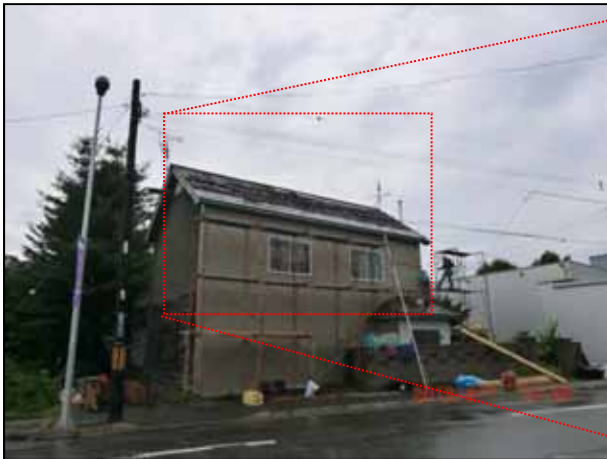
屋根のトタンが剥離した住家
