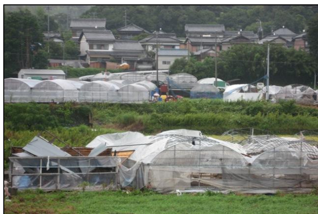
図 4 - 6 撮影場所⑥ 安芸市役所提供 ビニールが一部捲れたり、変形したビニールハウス
