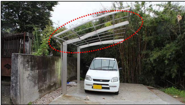
図 4 - 9 撮影場所⑨ ルーフが飛散し、骨組みが捻じれたカーポート
