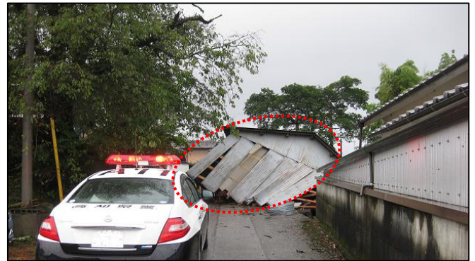
図 4 - 10 撮影場所⑩ 安芸市役所提供 北（左側）から南に数メートル移動し、倒壊して市道を塞いだ倉庫
