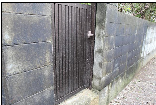
図 4 - 3 撮影場所③ 南北に走る路地の西側にあるブロック塀や戸に泥が付着している。
