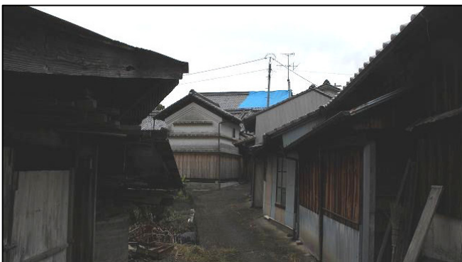
図 4 - 13 撮影場所⑬ 屋根瓦（大棟）の一部が捲れた住家
