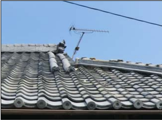
① アンテナが傾き屋根瓦がめくれた住家 [安濃町清水]
