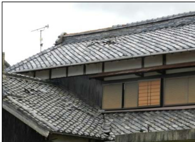
③ 屋根瓦がめくれた住家 [安濃町清水] 【津市提供】
