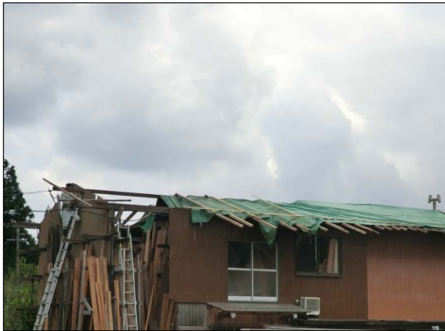
① トタン屋根が飛ばされた事務所 （緑色防水シートで補修中） [藤原町大貝戸]
