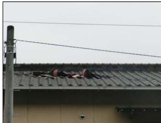
④ 屋根瓦がめくれた住家 (北から撮影)
