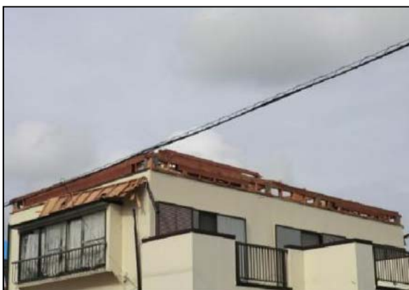
③ 屋根が飛散した住家 (南南西から撮影)
