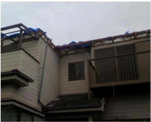
③ 屋根が飛散した住家 （千葉県野田市桐ヶ作）
