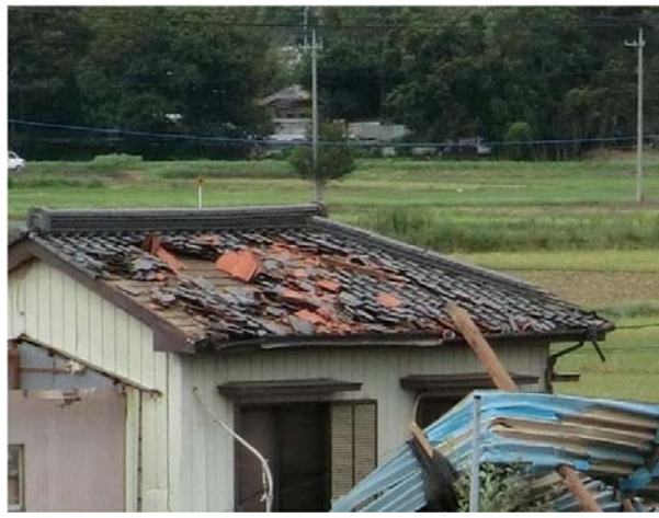
④ 屋根瓦が飛散した住家 （茨城県猿島郡境町桐ヶ作）
