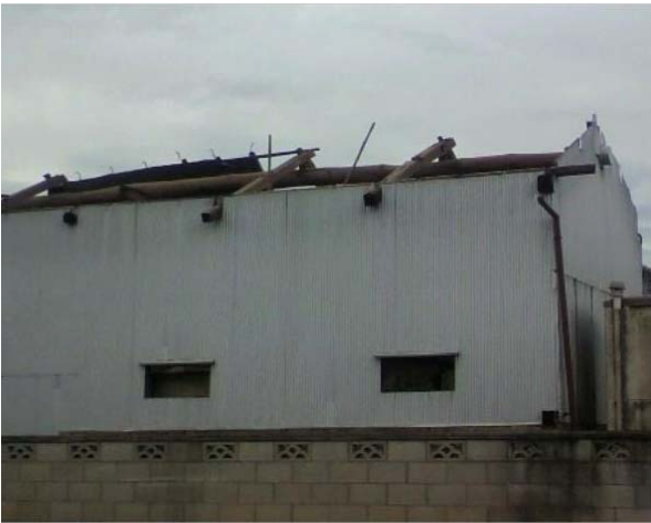
① 屋根が飛散した非住家 （千葉県野田市桐ヶ作）
