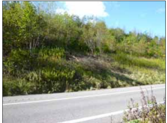
地点 3 (北西方向を撮影、部外資料) 切土法面で東南東方向へ倒れた樹木
