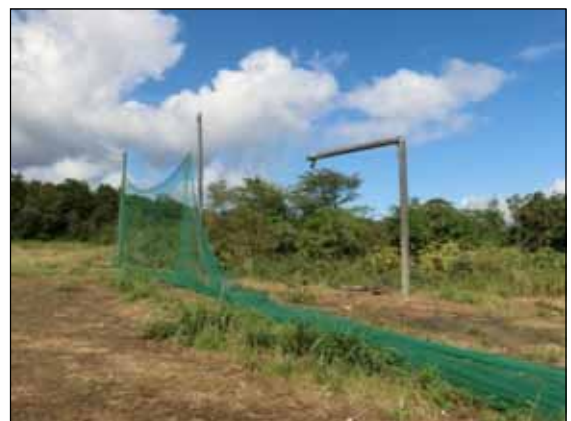
地点7 (北西方向を撮影) 西方向に折損したコンクリート支柱 (太さ30cm)
