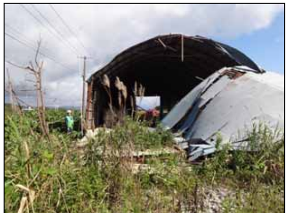
地点22 (北方向を撮影) 東方向に飛散した老朽化したD型ハウス
