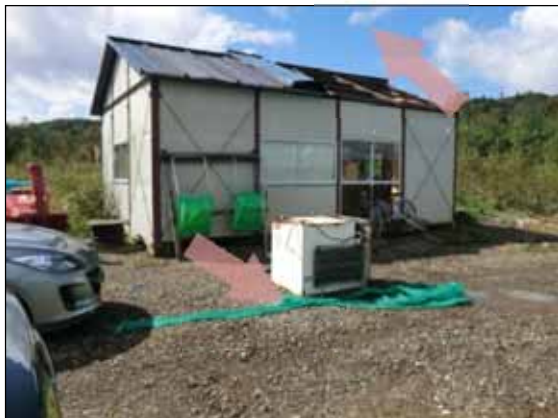
地点8（南西方向を撮影） トタン屋根の一部が南南西方向に剥離した非住家（プレハブ小屋）及び東方向へ横転した屋外の冷蔵庫
