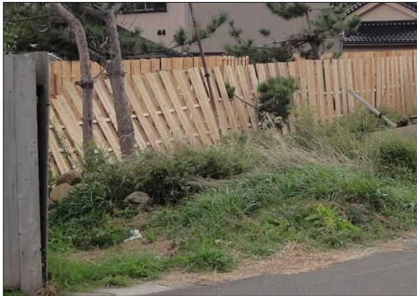
① 東側に倒れた木製の塀 (北西から撮影)
