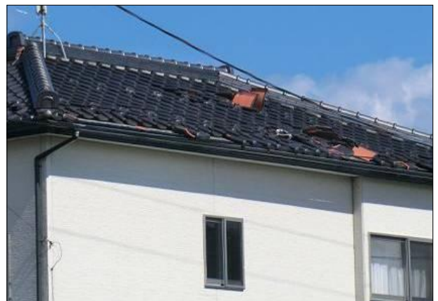
⑥ 2階南側の屋根の瓦が一部めくれた住家 (南西から撮影)
