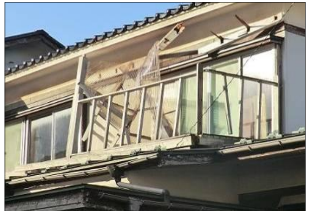
④ 2階南西側の木製ベランダが破損した住家 (南から撮影)
