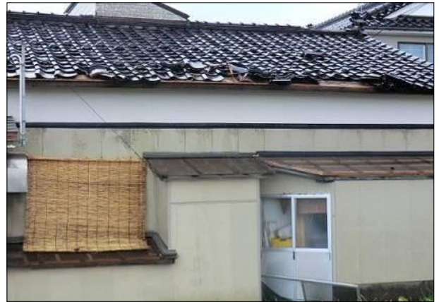
② 西側の屋根の瓦が一部めくれた住家 (西から撮影)
