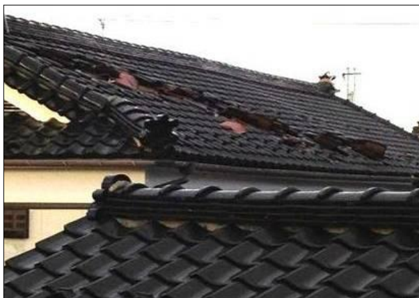
⑤ 2階南東側の屋根の瓦が一部めくれた住家 (南から撮影)
