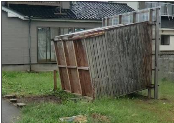
③ 東側に倒れたごみ集積小屋 (南南西から撮影)
