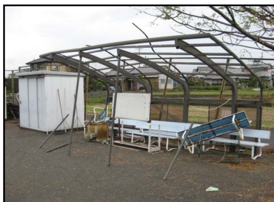
④ 屋根が破損した広場の休憩所と 北方向へ移動した物置き (南から撮影) 【藤枝市提供】
