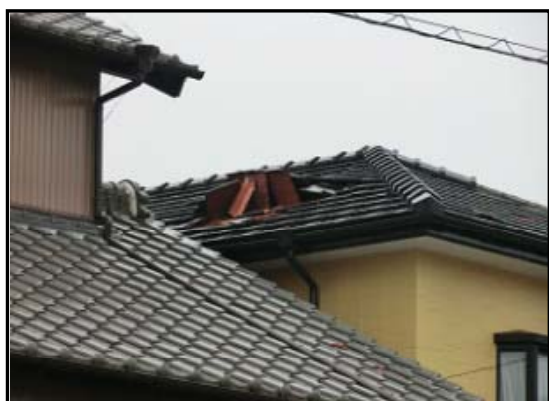
③ 瓦がめくれた住家 (北東から撮影)
