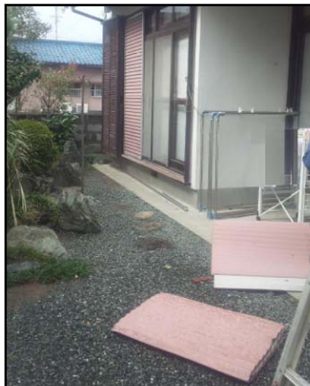
② 雨戸が飛散した住家 (南東から撮影)
