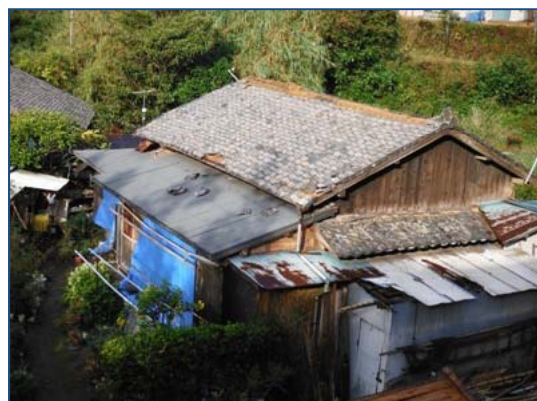
⑥屋根瓦がめくれ、飛散物により 窓ガラス が割れた住家(平戸市提供) (東から西に向かって撮影)
