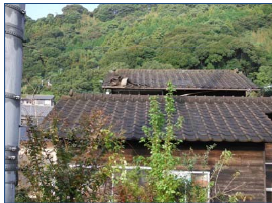
②屋根瓦がめくれた住家(平戸市提供) (南東から北西に向かって撮影)
