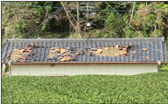
③屋根瓦がめくれた住家 （東南東から撮影）
