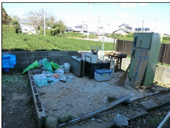
⑤屋根が飛散し、壊れた倉庫跡 （南西から撮影）
