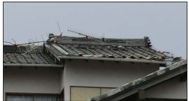
④アンテナが倒れ、屋根瓦がめくれた住家 （南から撮影）
