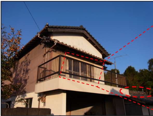
図 4 - 9 撮影場所⑧ 屋根の瓦が一部めくれた住家
