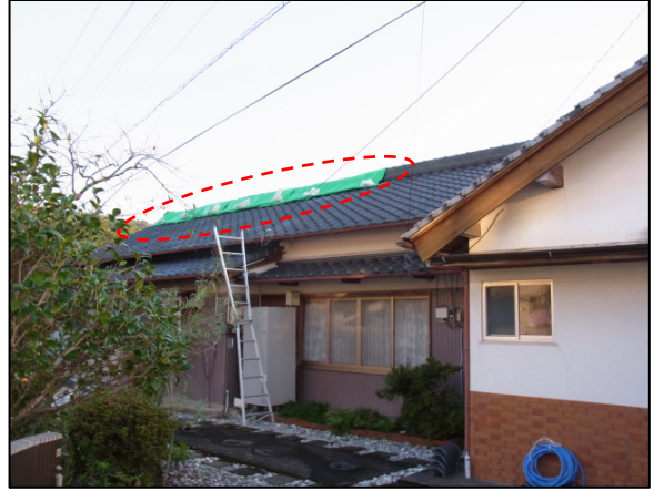
図 4 - 8 撮影場所⑦ 屋根（大棟）の瓦が一部飛散した住家
