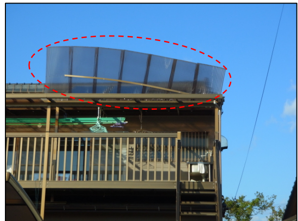
図 4 - 6 撮影場所⑤ ベランダの屋根の一部がめくれた住家
