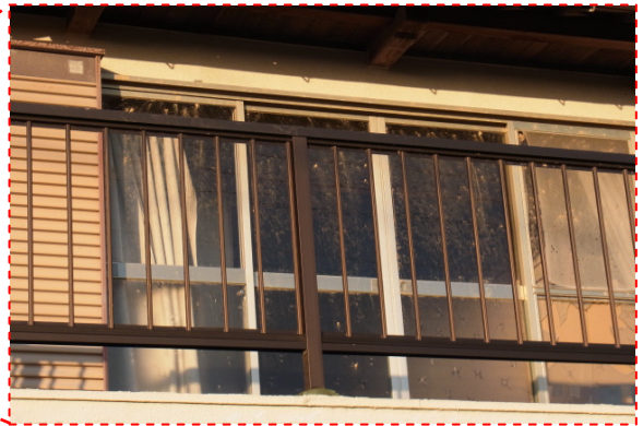
南側の窓や壁全体に泥が付着している。
