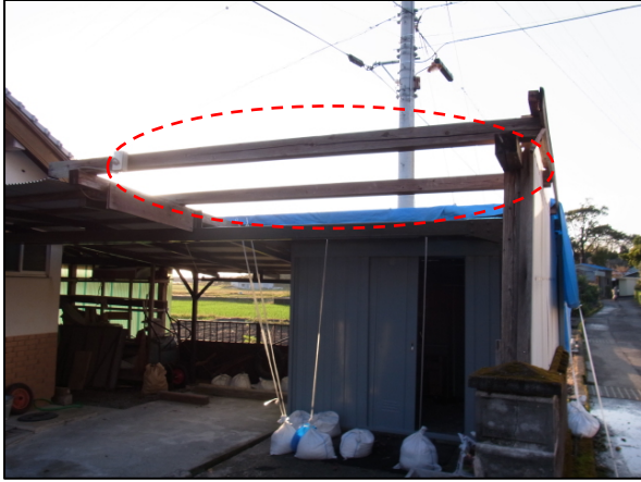
図 4 - 7 撮影場所⑥ 剥がれた屋根が北東方向に飛散した車庫
