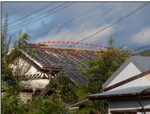
図 4 - 5 撮影場所④ 屋根(大棟)の瓦が一部めくれた住家
