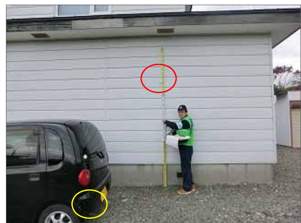
損傷した車両と東壁面高さ2.1mの位置が縦20cm横30cm損傷した住家。
