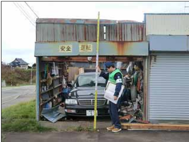
トタン屋根が飛散した非住家（車庫、木材部分は北東方向約100mのグラウンドに、トタン部分は北方向約200mまで飛散。写真は南に向かって撮影）。
