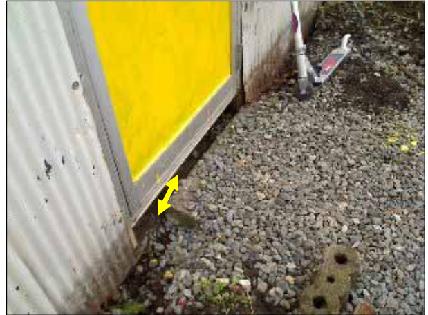
移動した非住家（物置小屋、踏み台のコンクリートと物置小屋の出入り口に16cmのずれが見られる）。
