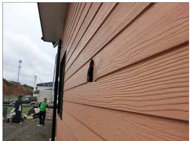
北側高さ1.8mの位置に飛散物により縦横10cmの穴があいた住家。泥の付着も確認された。
