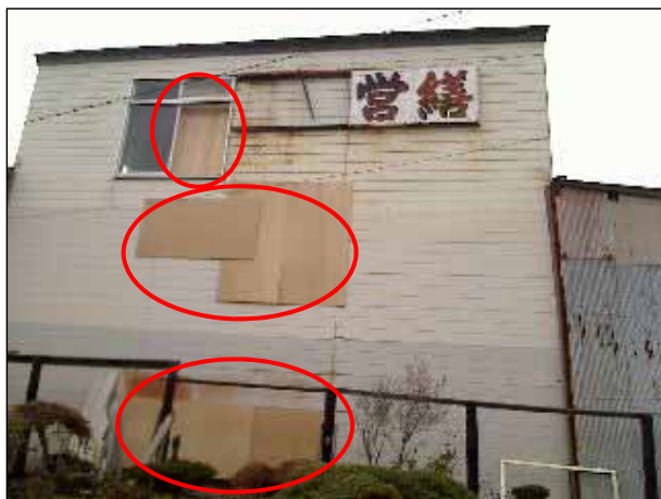
西側のシャッターが風で破損した倉庫。内部を風が吹き抜けて反対側の壁材等を破損。(写真は破損した東側)
