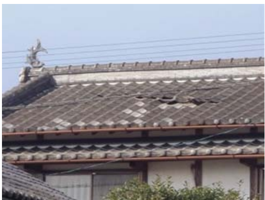
④南側の屋根の瓦がめくれてズレた住家
