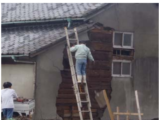
②モルタル壁が剥離した倉庫
