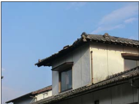
①北側の屋根の瓦がめくれてズレた住家
