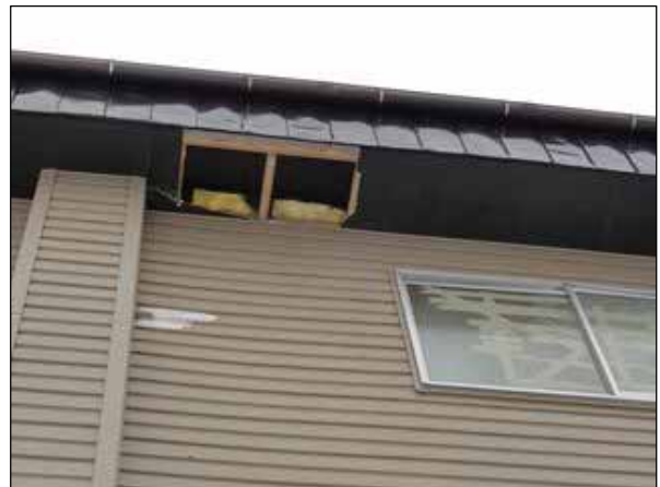
飛散物により、北側壁面が破損した住家
