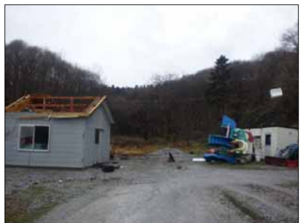
屋根が剥離し北東方向に飛散した非住家 (写真：様似町提供)
