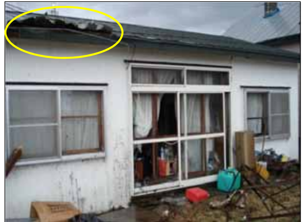
の物置の飛散物がぶつかり、南側の窓ガラスが割れ、屋根のトタンが剥離した住家 （写真：様似町提供）
