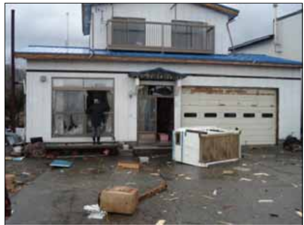
の位置にあったゴミ箱がぶつかり南側の窓ガラスが割れた住家 （写真：様似町提供）
