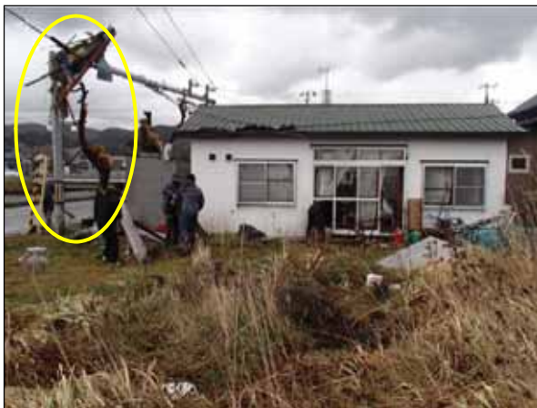
飛散物（物置）により折損した電柱 （写真：様似町提供）
