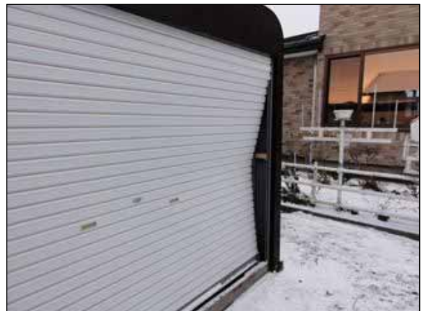
風圧により東側のシャッターがへこんだ非住家（車庫）
