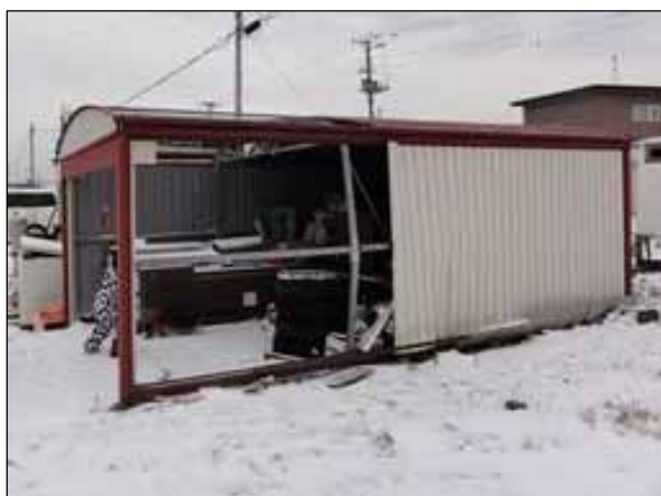
北側側面部が損壊した非住家（車庫：空いていた東側のシャッターから風が入り破損、その他の部分も内側から押された跡あり）
