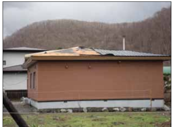
屋根のトタンが剥離した住家(剥離部分は北西側と東側の一部、剥離したトタンはの地点に飛散)
