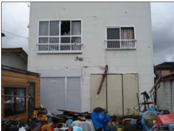
の物置の木片等飛散物が南側壁面に刺さった住家 （写真：様似町提供）
