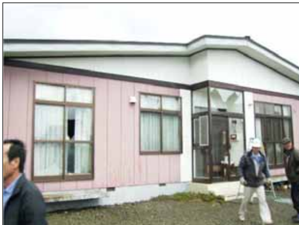
飛散物により南側のガラスが破損した住家 (写真：様似町提供)
