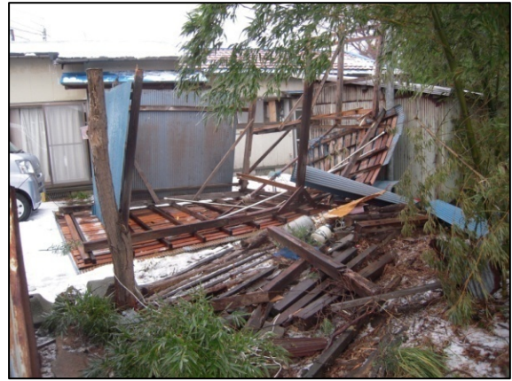
② 損壊した物置小屋（遊佐町提供）
