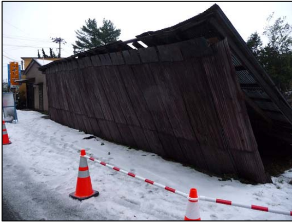
① 北側に傾いた物置小屋
