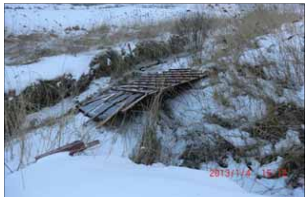
北東に約50m飛散した の屋根の一部
