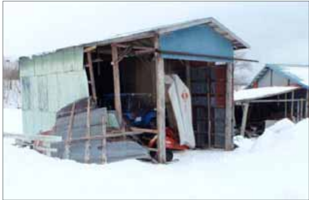
北方向の壁面が外側にめくれた非住家（車庫） （写真は新ひだか町提供）
