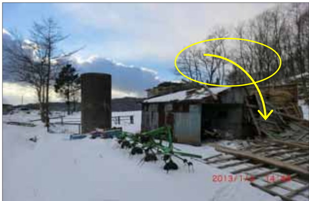
2階部分が北東方向に飛散した非住家（納屋）
