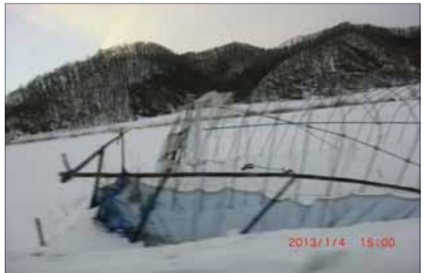
北東方向に倒れたビニールハウス
