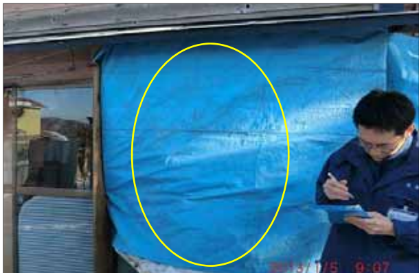
風圧により南西側の窓ガラスが割れた住家
