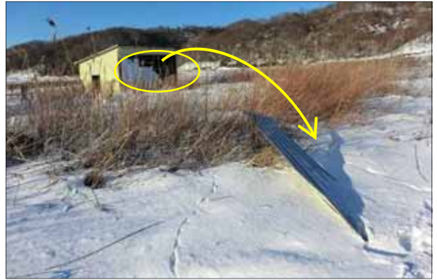
壁面のトタン及びプラスチック片が東方向に飛散した非住家（倉庫）
