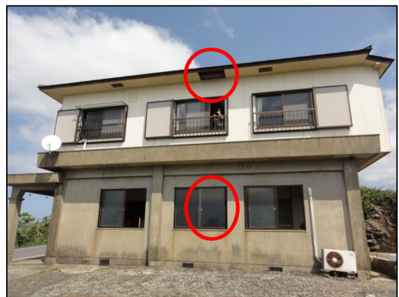
④窓ガラスが割れ、屋根のひさしが一部めくれた住家 (窓ガラスは補修済み 北に向かって撮影)
