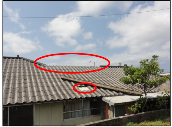
⑥屋根瓦がめくれた住家(西に向かって撮影)
