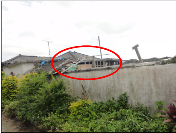
⑤屋根のトタンがめくれた牛舎 (東に向かって撮影)
