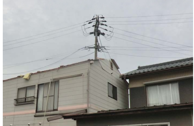
② 屋根が飛散した住家（写真左側） (東北東から撮影)
