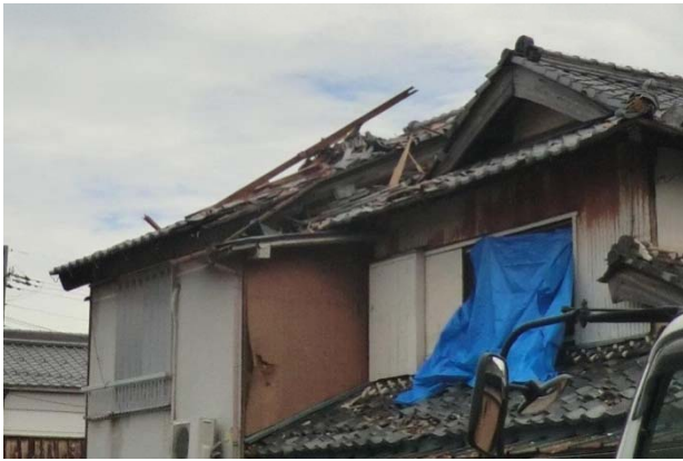
③ 瓦が飛散し屋根が一部破損した住家 (西南西から撮影)
