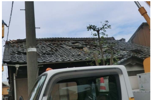
④ 瓦がめくれた住家 (東南東から撮影)
