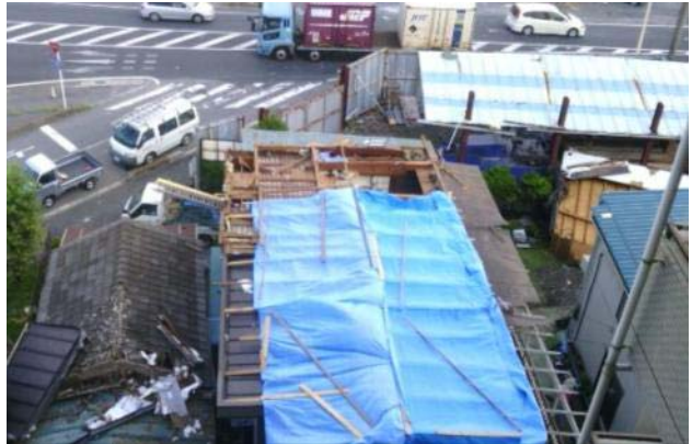
② 屋根が飛散した住家 (埼玉県越谷市下間久里、上から撮影)
