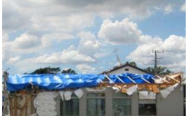
⑧ 屋根が飛散し外壁が損壊した住家 (埼玉県北葛飾郡松伏町大川戸)
