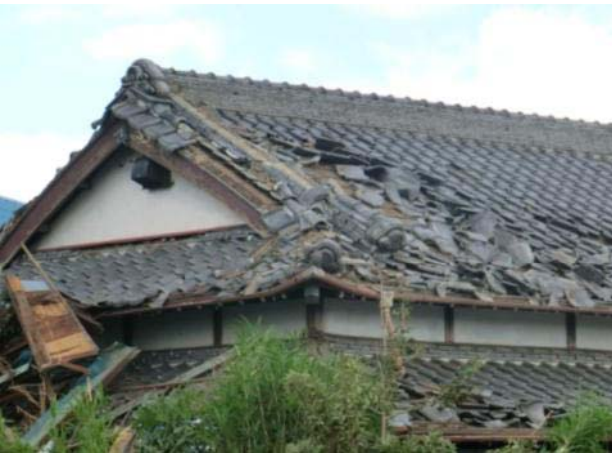
⑨ 屋根瓦がめくれた住家 (埼玉県北葛飾郡松伏町築比地)
