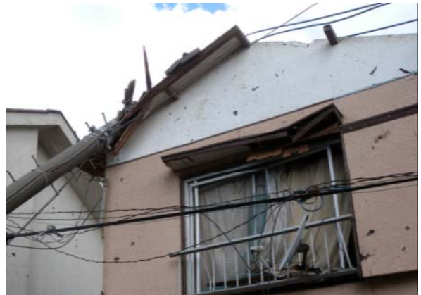
④ 屋根の一部や屋根瓦が飛散し、 外壁にも飛散物の被害を受けた住家 (埼玉県越谷市大杉)
