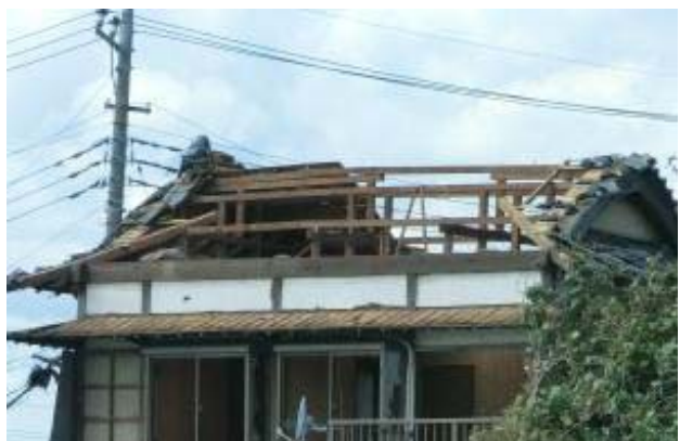
⑥ 屋根瓦が飛散し屋根下の構造まで 破損した住家 (埼玉県越谷市船渡)
