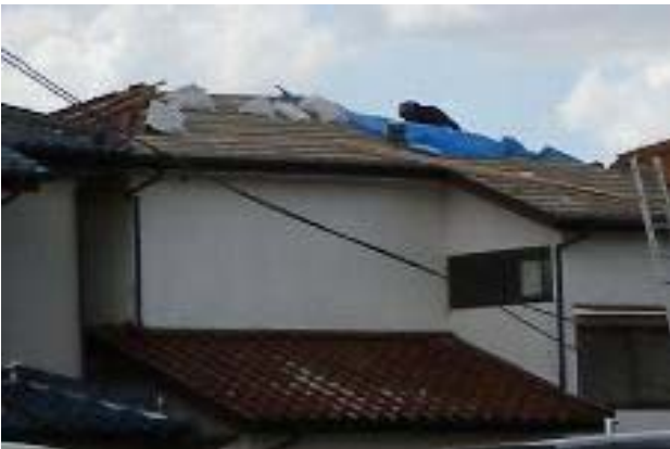
③ 屋根瓦が飛散した住家 (埼玉県越谷市大杉)
