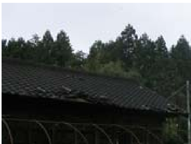
⑤ 屋根瓦がめくれた非住家 （宇都宮市飯田町）
