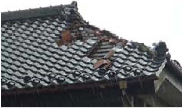
① 屋根瓦がめくれた住家 （鹿沼市茂呂）
