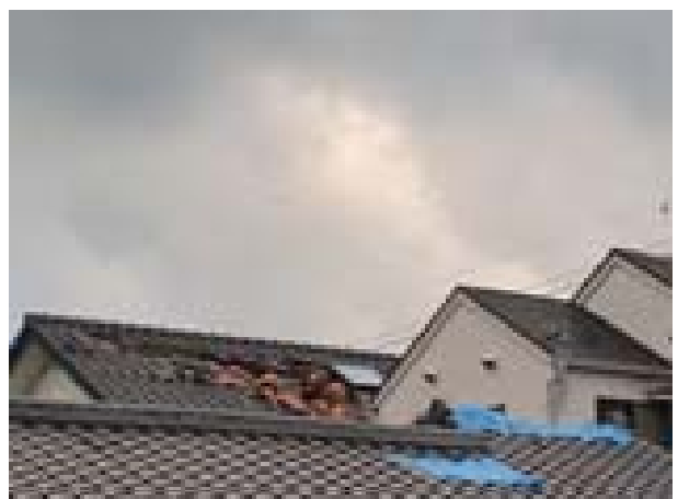
⑥ 屋根瓦がめくれた住家 （矢板市鹿島町）
