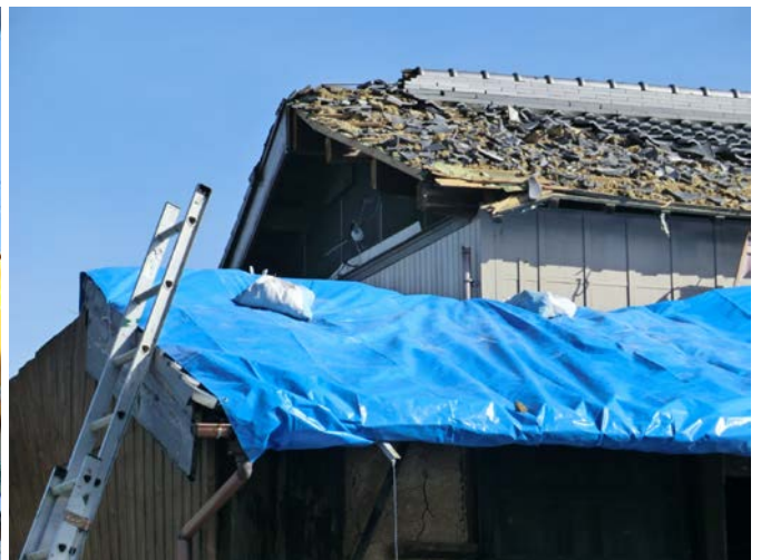
④ 田並地区：屋根瓦が飛散した住家
