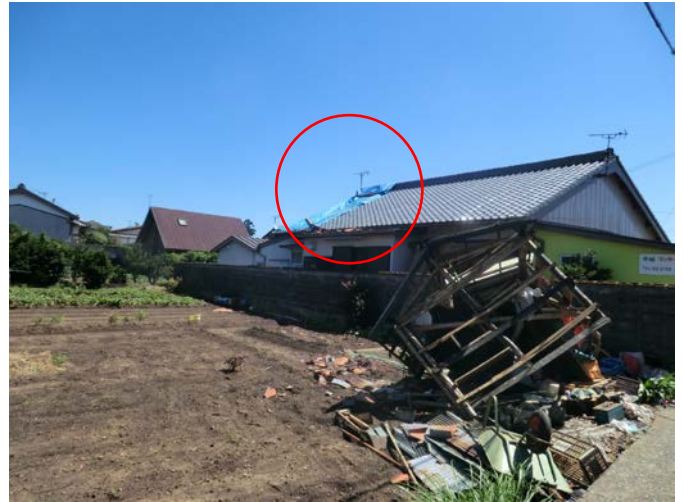
② 平松地区：屋根瓦がめくれた住家及び倒壊した小屋
