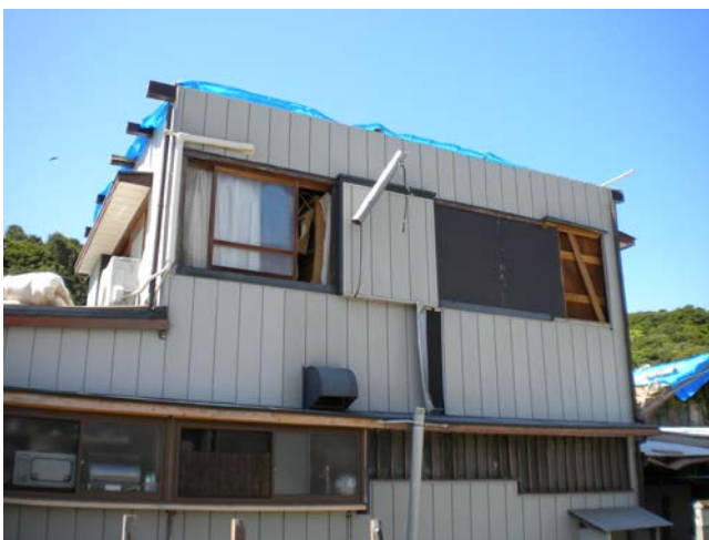
⑨ 串本地区：屋根が飛散した住家
