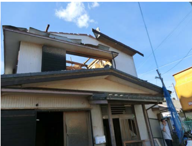
③ 田並地区：屋根が飛散した住家
