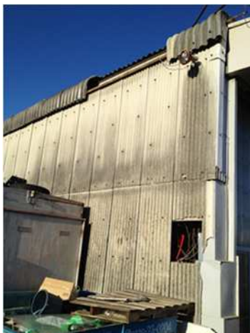
⑨スレート屋根一部が飛散した工場 (南西から撮影)
