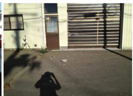
⑪散乱したスレート破片(西から撮影)
