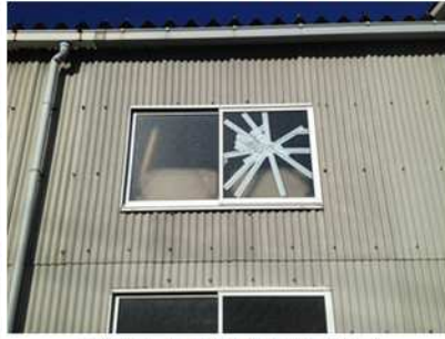
⑫破損した倉庫2階サッシガラス (南西から撮影)
