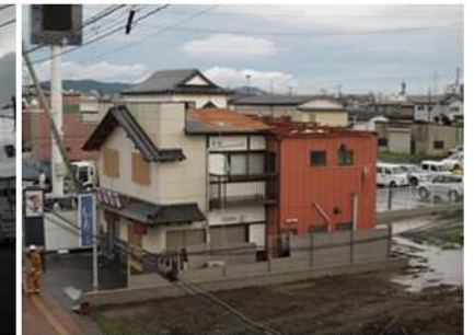
⑱屋根が飛散したカラオケ店 (北西から撮影、石巻広域消防提供)
