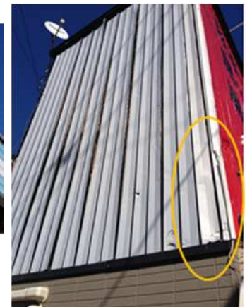
㉔北側にめくれたトタン (西から撮影)
