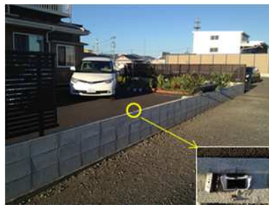
⑦北側にちぎれ倒れた同じアルミ製フェンス(手前)と倒れたフェンス(奥) (南西から撮影)
