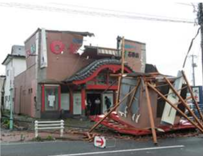
⑲2階の木製飾りが北側に落下した仏具店 (石巻広域消防提供、北から撮影)
