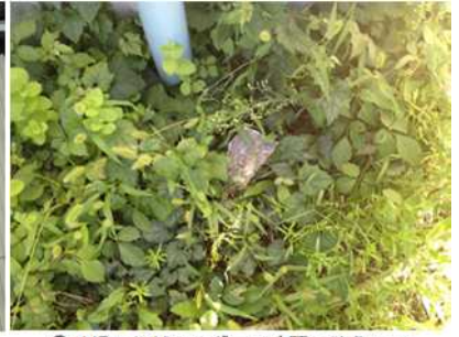
⑬破損したサッシガラス直下に散乱していたスレートの破片
