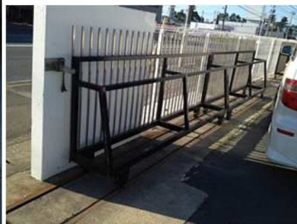
⑩東側(手前)に倒れた門扉フェンス (南東から撮影)
