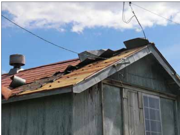
A9 屋根のトタンが一部剥離した非住家（物置）
