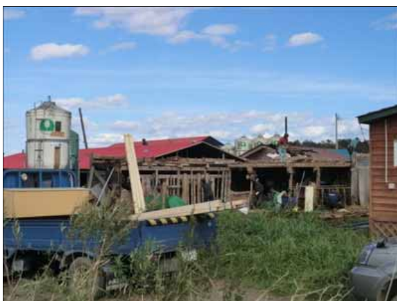
A5 2階部分が損壊し東方向に飛散した 非住家(牛舎)
