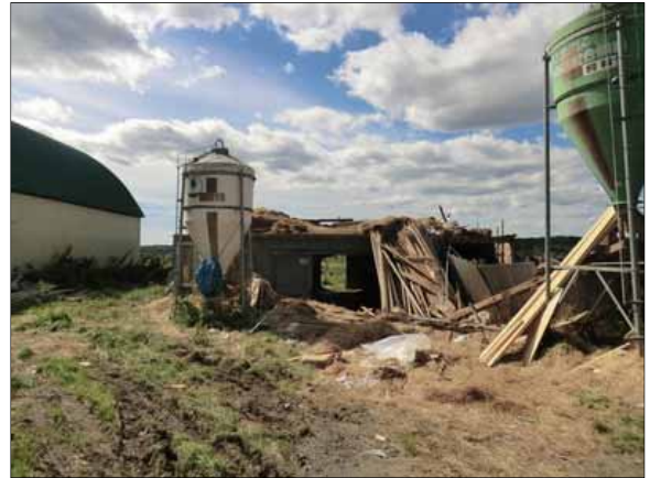
A2 屋根が東方向120mに飛散した非住家 (牛舎)
