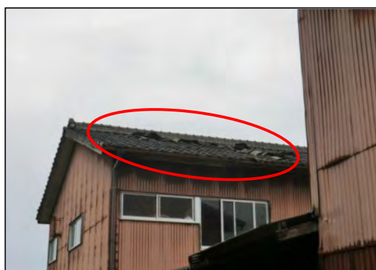
A : 屋根瓦のめくれた住家 (南から撮影)
