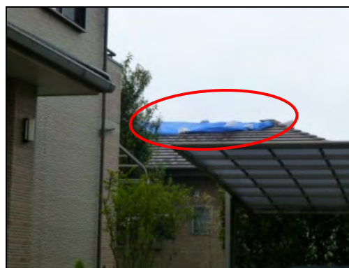
I: 屋根瓦のめくれた住家 (北から撮影)
