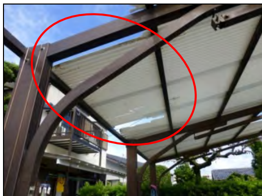
F: 一部破損したカーポート (東から撮影)
