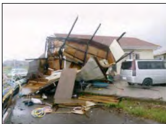
C : 倒壊したプレハブ倉庫 (高鍋町役場提供) 基礎部分は鉄骨で腐食が見られた 基礎から西側に約 7m 移動した (北から撮影)
