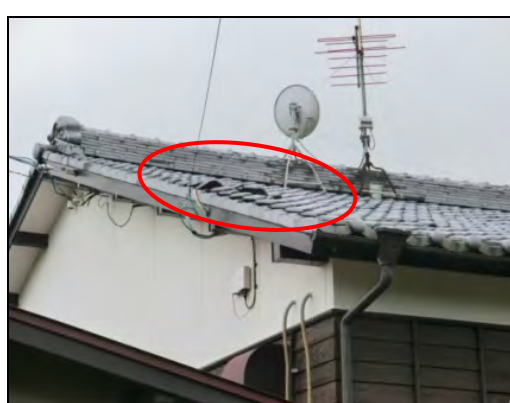
D : 屋根瓦のめくれた住家 (北東から撮影)
