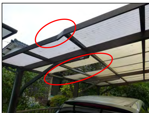
H: 支柱の変形したカーポート (東から撮影)
