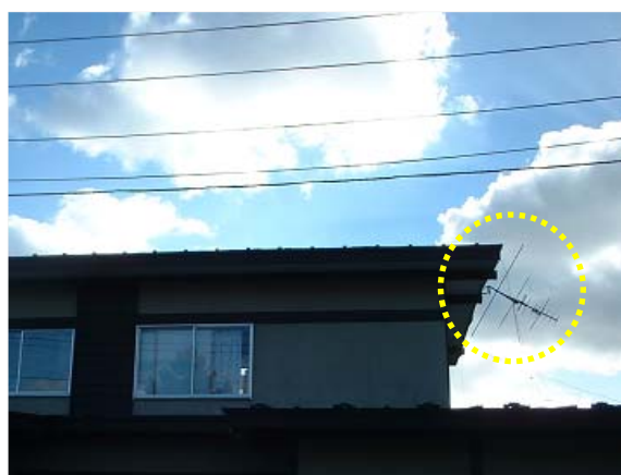
③住家のアンテナ折損(北から撮影)。
