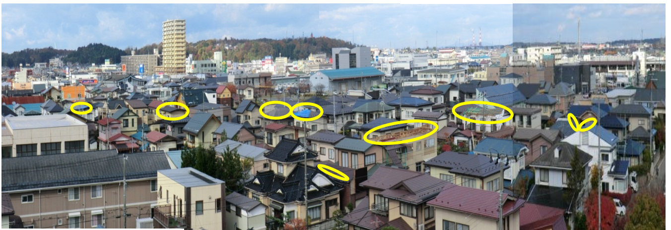
⑤ 中学校の屋上から撮影した屋根の被害状況 (東南東から撮影：黄色○は被害箇所)
