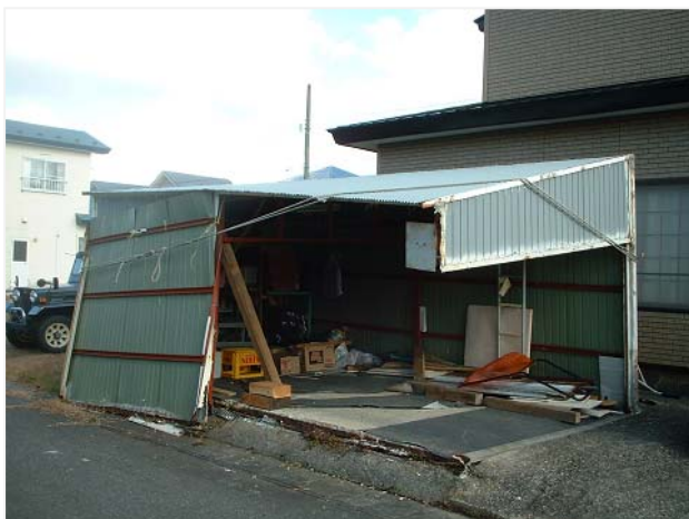
①車庫が半壊(南西から撮影)。
