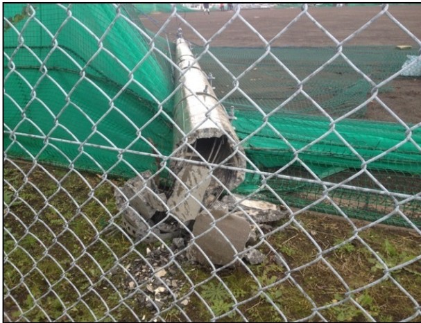
③ 中学校グラウンド西側のネット支柱が東側へ倒壊 (西から撮影)
