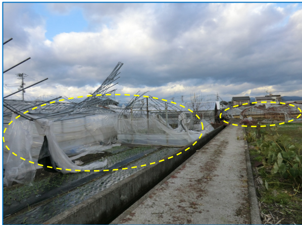
図 6-13 撮影場所 地域 B⑫ ビニールがめくれ、大きく変形した 10 棟以上のビニールハウス
