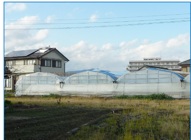
図 7-12 撮影場所 地域 C⑫ 東西方向に隣接する 7 棟の内、変形した西側 3 棟のビニールハウス（修復済み）
