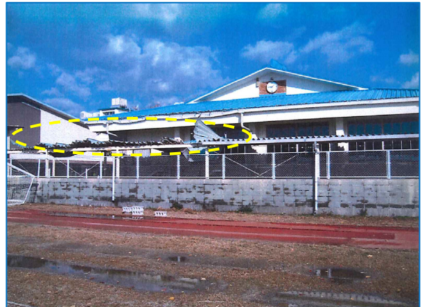
図5-4 撮影場所 地域A④ トタン屋根がめくれた渡り廊下 （写真提供：高知工業高等専門学校）
