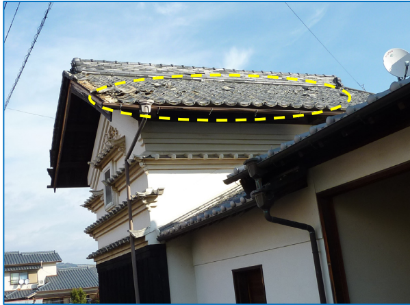
図 10-9 撮影場所 地域 F⑨ 南面の屋根瓦の一部が東にめくれた倉庫（蔵）
