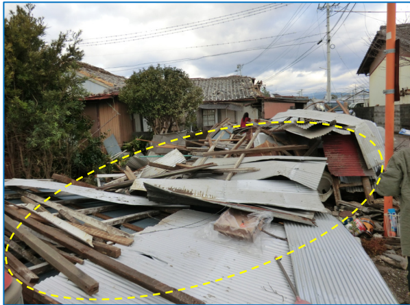
図 6-11 撮影場所 地域 B⑩ 北側に倒壊した車庫
