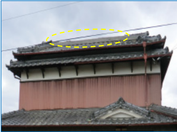
図 8-5 撮影場所 地域 D⑤ 棟瓦が東（写真では手前）にめくれた住家
