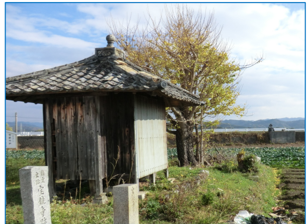
図 10-12 撮影場所 地域 F⑫ 南西側の棟瓦が5mほど南東に落下した堂
