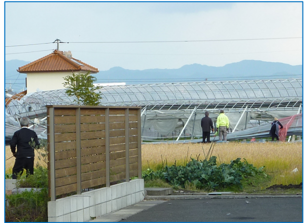
図 6-8 撮影場所 地域 B⑦ 9 棟中 5 棟のビニールがめくれ、大きく変形した ビニールハウス
