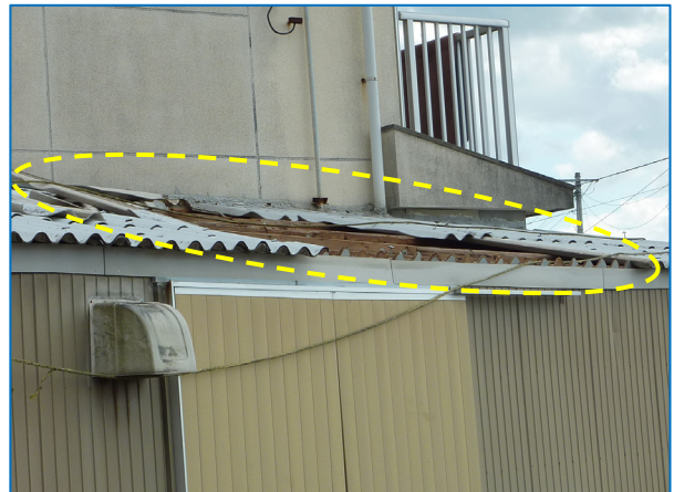
図 8-2 撮影場所 地域 D2 スレート屋根の一部がめくれた物置
