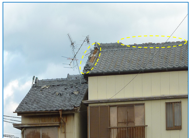
図 6-10 撮影場所 地域 B⑨ 棟瓦が北側にめくれ、アンテナが北側に傾いた住 家
