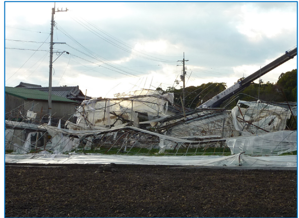
図 6-12 撮影場所 地域 B⑪ ビニールがめくれ、大きく変形した 8 棟のビニールハウス
