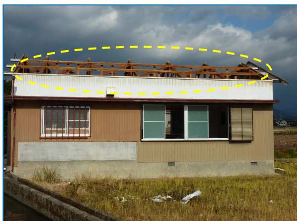
図 7-5 撮影場所 地域 C⑤ 屋根がはぎとられ、北北東方向に飛散した公民館
