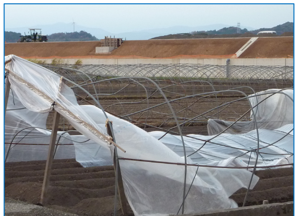
図 9-4 撮影場所 地域 E④ 西から東方向に押されたように変形した 3~5 棟のビニールハウス（支柱なし）
