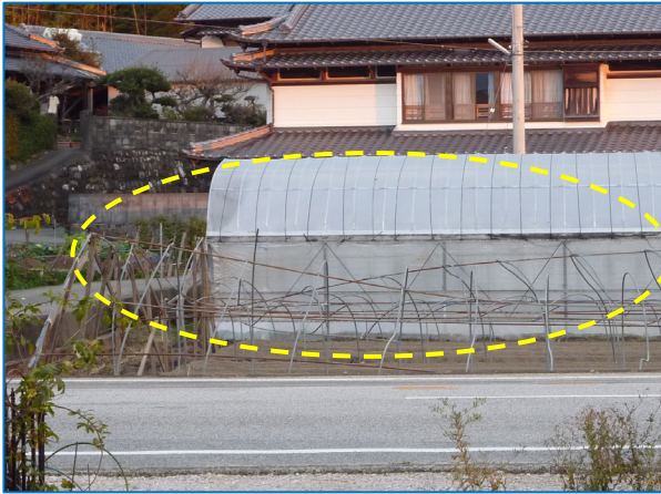
図 9-1 撮影場所 地域 E① 西から東方向に押されたように変形した 2 棟のビニールハウス（支柱なし）（1 棟は修復されている。）
