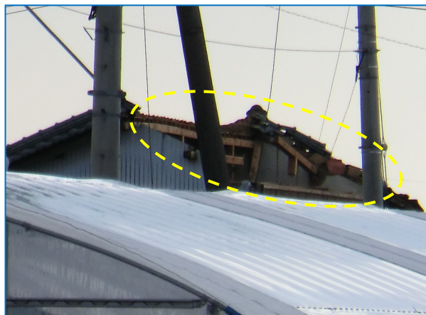
図 7-2 撮影場所 地域 C② 西面の屋根がはぎとられ、東方向に飛散した住家
