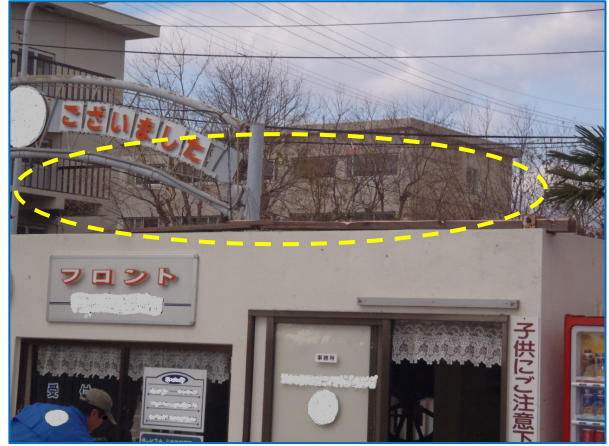
図5-2 撮影場所 地域A② 屋根が北側に飛散した駐車場事務所
