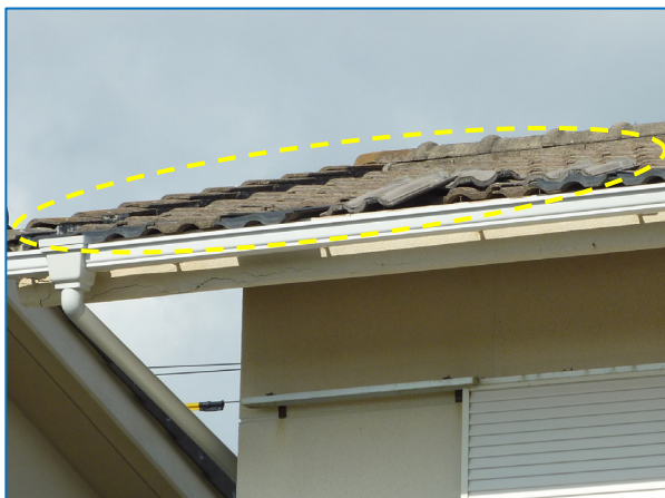
図 8-3 撮影場所 地域 D3 スレート屋根の一部がめくれた住家
