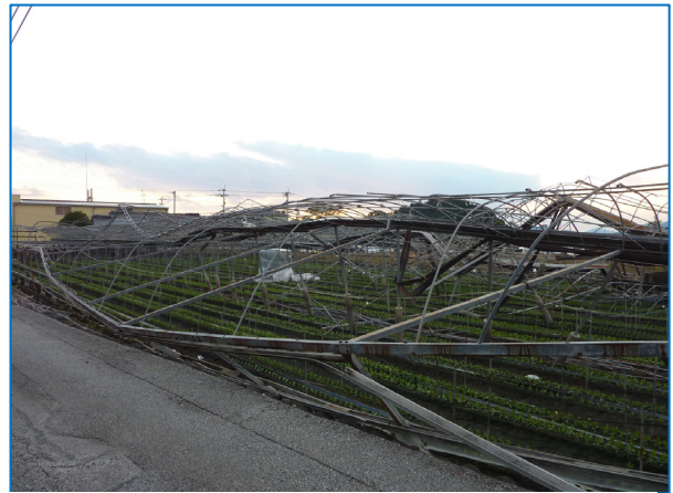
図 6-14 撮影場所 地域 B⑬ 東側に押されるように大きく変形したビニールハウス
