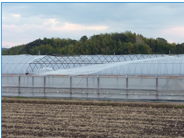
図 9-3 撮影場所 地域 E③ 上から押されたように変形した 2 棟のビニールハウス（支柱なし）
