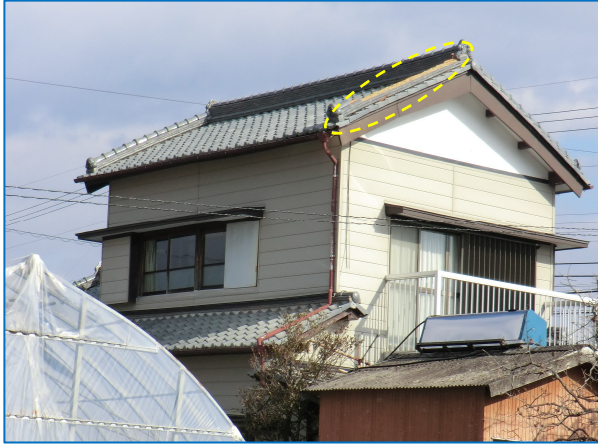
図 10-7 撮影場所 地域 F⑦ 西面の棟瓦がめくれた住家
