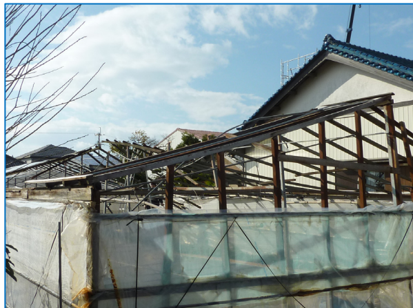
図 10-11 撮影場所 地域 F⑪ 北側半分ほどのビニールがめくれ、一部の支柱が曲がった2棟のビニールハウス
