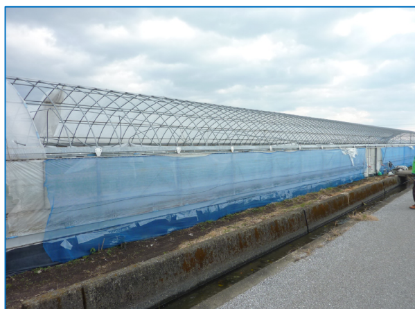
図 7-6 撮影場所 地域 C⑥ 隣接する 6 棟の内、ビニールがめくれた、西端に 位置するビニールハウス
