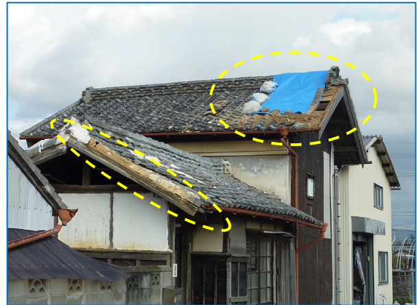
図 7-10 撮影場所 地域 C⑩ 西面と南面の屋根瓦が一部めくれた住家
