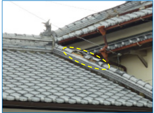
図 8-6 撮影場所 地域 D⑥ 棟瓦の一部がめくれた住家
