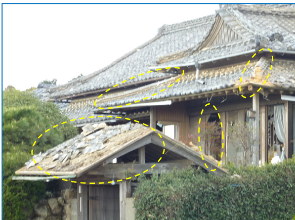
図 6-9 撮影場所 地域 B⑧ 南面の窓ガラスが割れ、主に南面の屋根瓦がめく れた住家
