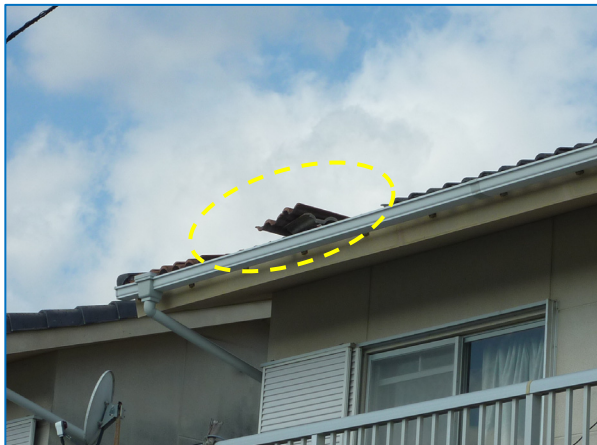
図 8-1 撮影場所 地域 D1 南面のスレート屋根の一部（南西側）がめくれた住家
