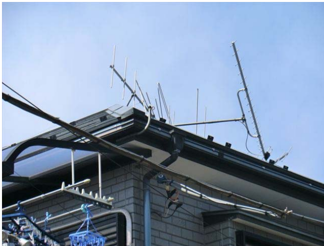
③北東へ倒れたアンテナ (南東から撮影)
