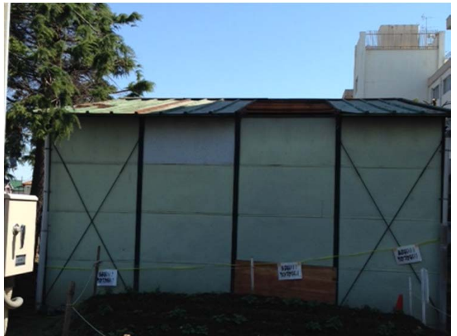
②トタン屋根の一部が飛散した倉庫 (西から撮影)
