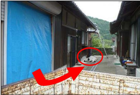
飛散したシャッター (復旧作業中)
