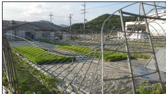
支柱が曲がったビニールハウス (ビニールは撤去済み)
