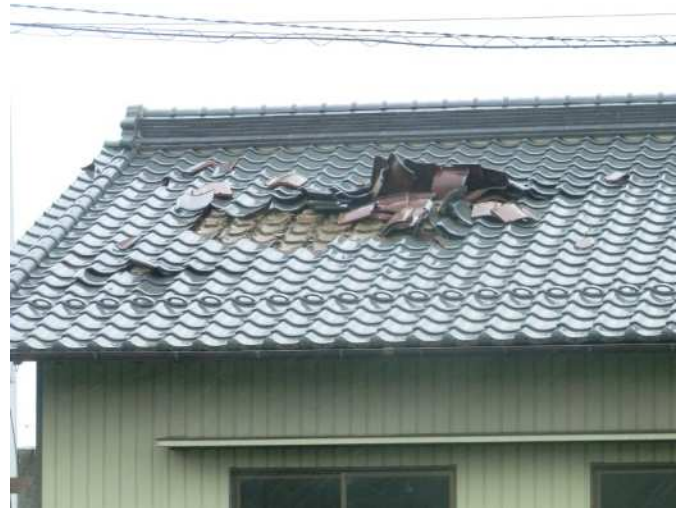
屋根瓦がめくれた非住家
