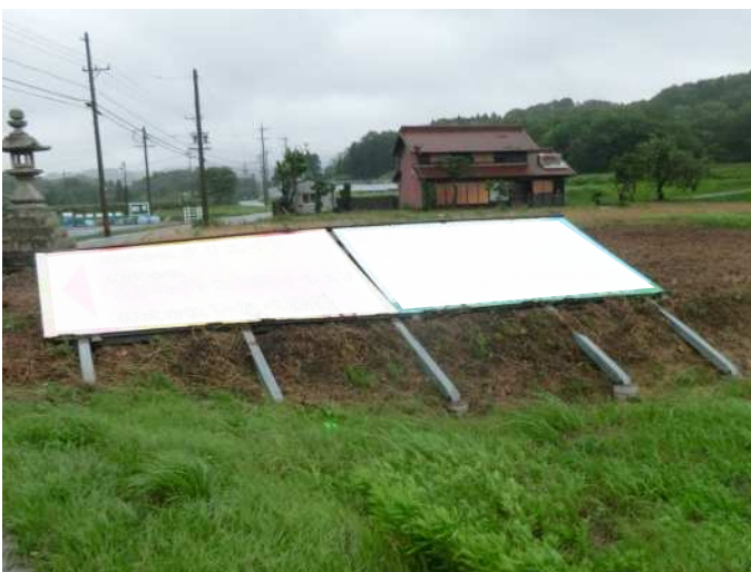
支柱が折れ曲がった看板
