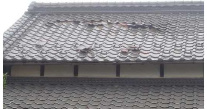
屋根瓦がめくれた住家 【いなべ市提供】
