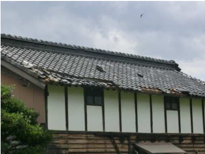
屋根瓦がめくれた住家
