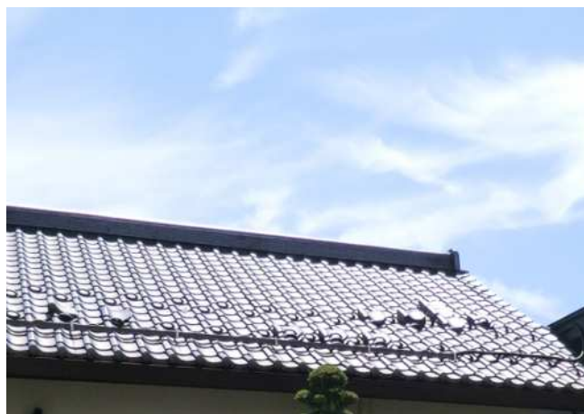
屋根瓦がめくれた住家
