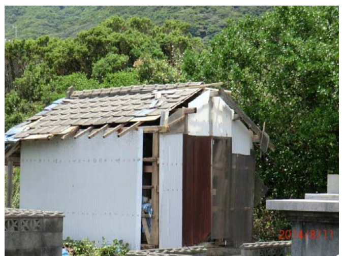
図4-2 撮影場所2 東面の屋根瓦が一部めくれた倉庫
