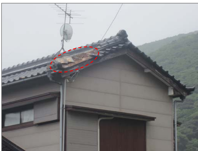
図4-1 撮影場所1 (室戸市役所提供) 東面の屋根瓦が一部めくれた住家
