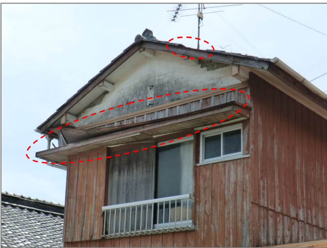
図 4 - 5 撮影場所 5 北西側のひさし(トタン)の一部が破損し、西面の屋根瓦が一部めくれた住家
