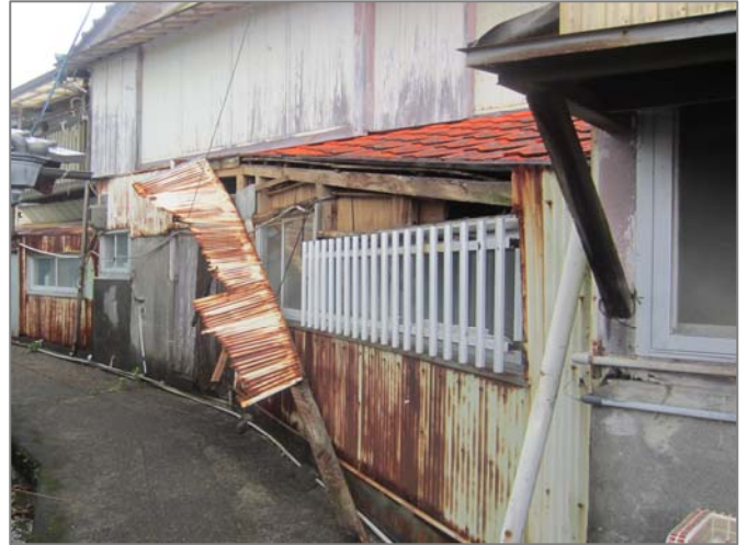
図 4 - 4 撮影場所 4 (室戸市役所提供) 南側のトタン屋根が一部破損した非住家
