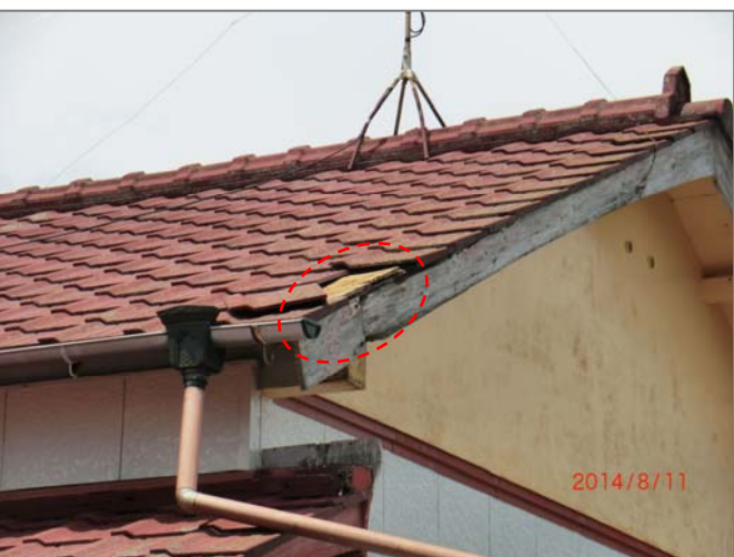
図 4 - 7 撮影場所 7 南面屋根が一部めくれた住家
