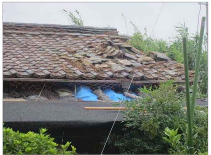
図 4 - 6 撮影場所 6 (室戸市役所提供) 南面屋根が一部破損し、瓦がめくれた住家
