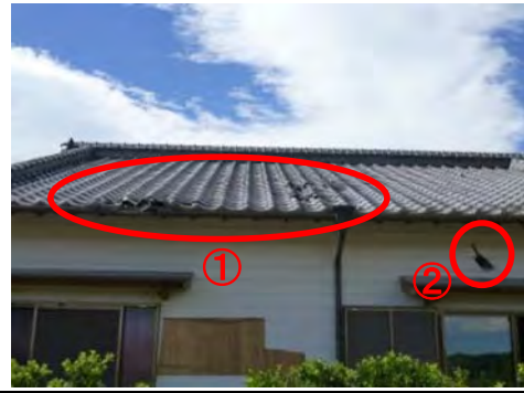
9: ① 飛散物による屋根瓦の損壊 ② 飛散した屋根瓦が刺さった壁 (北から撮影)
