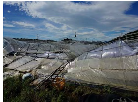
11: 南西に倒壊したビニールハウス (北東から撮影)
