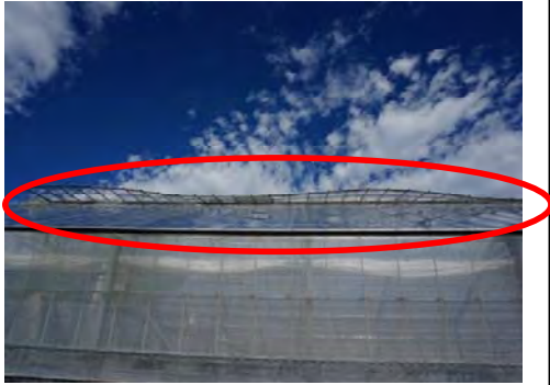
10: 一部損壊したガラス製ハウス (東から撮影)
