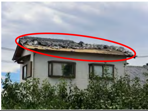
8: 屋根瓦がめくれ、一部南西方向に 飛散した住家(北東から撮影)
