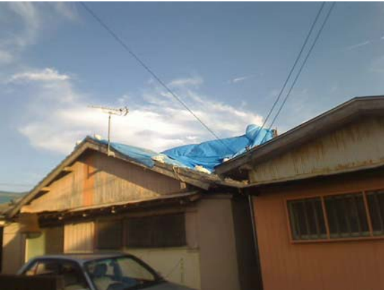
図 7-5 写真⑤ 屋根瓦がめくれて補修のためにブルーシートがかけられた住家
