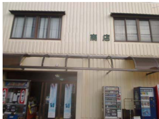
図 7-2 写真② アクリル板のひさしが飛散した商店
