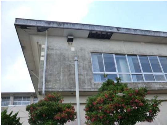
図 5-3 写真③ 石膏ボードが一部落下した体育館
