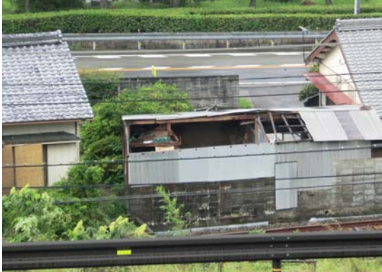
図 5-1 写真① プラスチック製波板の屋根が飛ばされた倉庫
