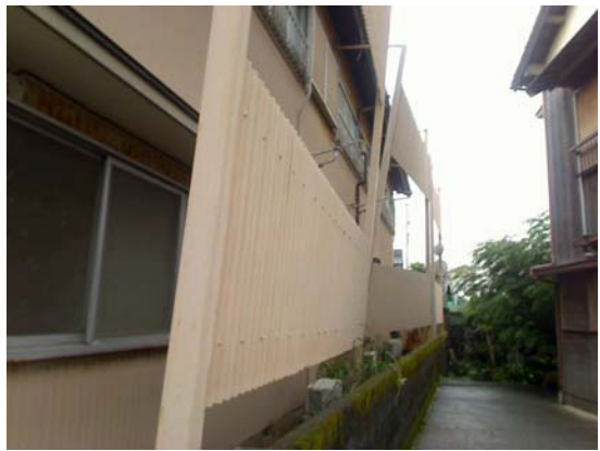
図 7-6 写真⑥隣家との間の目隠し板が傾いたアパート
