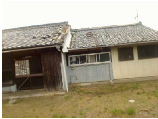
図 7-4 写真④ 屋根瓦がめくれた住家
