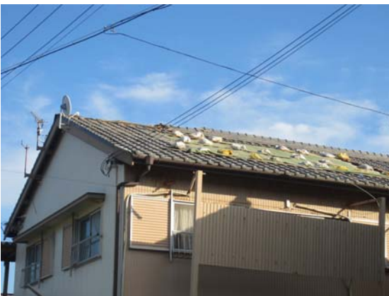
図 7-7 写真⑦ 屋根瓦がめくれたアパート
