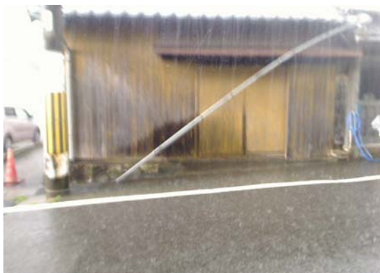
図 7-1 写真① 樋が破損した非住家
