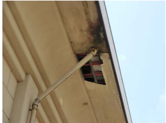
図 5-4 写真④ 石膏ボードが一部落下した体育館（南東部分の庇を拡大）
