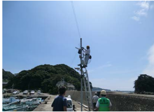
図 3-2 写真② 電源ケーブルが断線した監視カメラ
