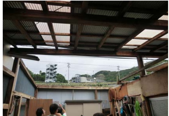
図 5-2 写真② プラスチック製波板の屋根が飛ばされた倉庫（内側から）
