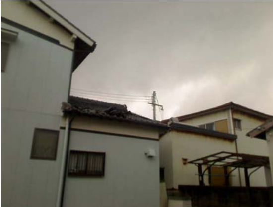
図 7-3 写真③ 屋根瓦がめくれた住家
