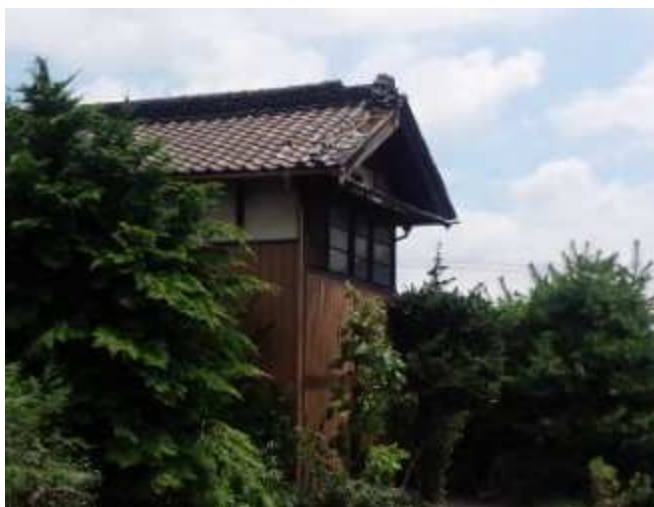
屋根瓦がめくれた住家 （栃木市平柳町）
