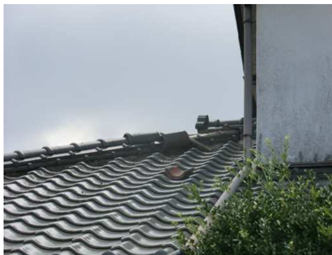
屋根瓦がめくれた住家 （鹿沼市上奈良部町）
