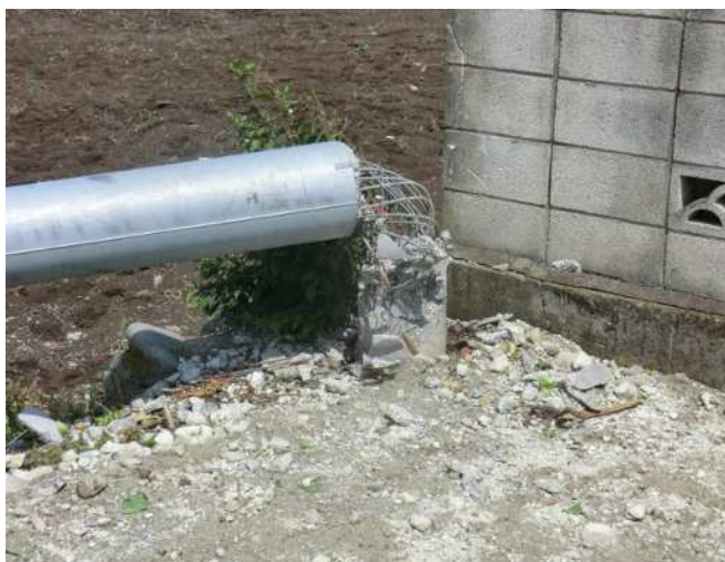
折れたコンクリート製の電柱 （鹿沼市北赤塚町）
