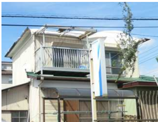
屋根の一部が飛散した住家 （栃木市都賀町合戦場）
