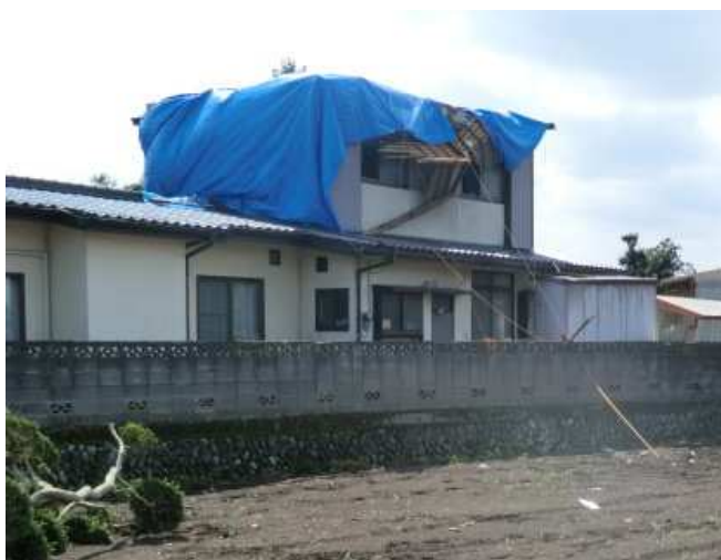
屋根が飛散した住家 （鹿沼市北赤塚町）
