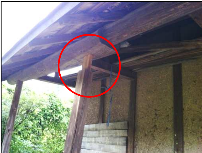
屋根が浮き上がった納屋 (南から撮影)
