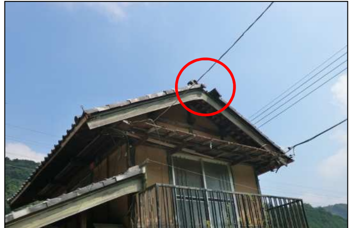
屋根瓦がめくれた住家 (南西から撮影)
