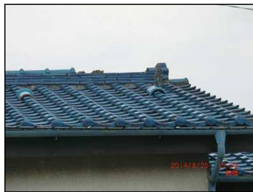
屋根瓦が落下した住家 (前橋市鳥羽町)
