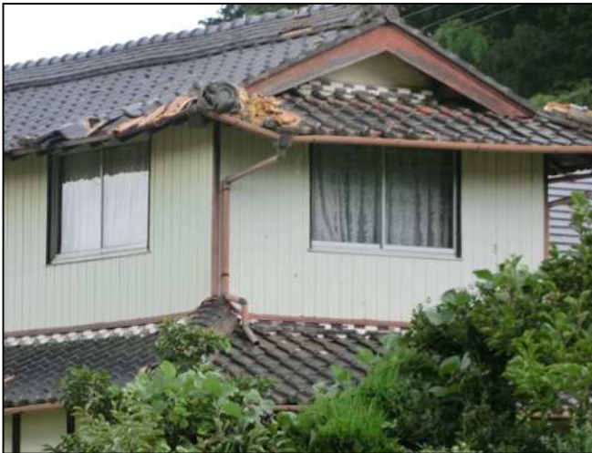
屋根瓦が落下した住家 (南西から撮影)
