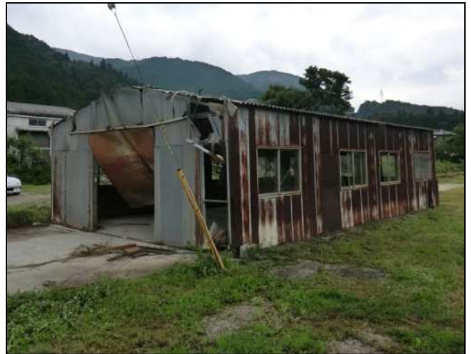
トタン屋根がはがれた非住家 (北西から撮影)
