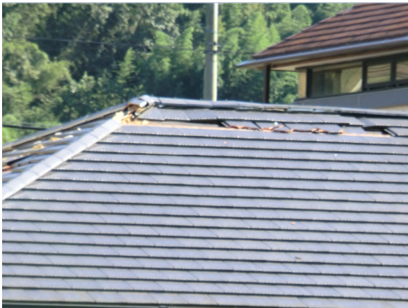
図 3-1 スレート屋根瓦が飛散した住家 撮影場所 図 2 - (北から撮影)
