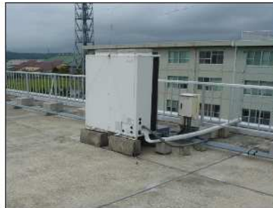
④横転したエアコン室外機
