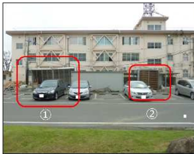
南側に横転したプレハブ小屋 ①6.2m×2.6m ②3.4m×2.6m 北側から撮影
