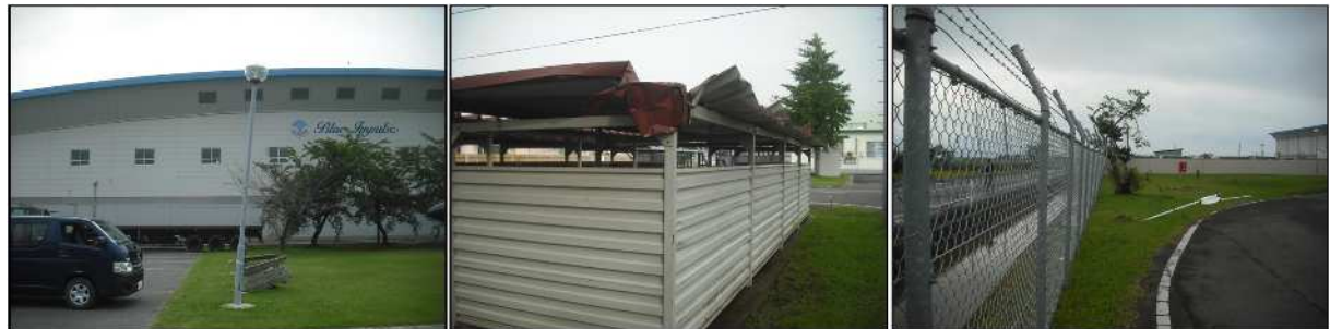
⑱-5 支柱が反った外灯* 北側から撮影
