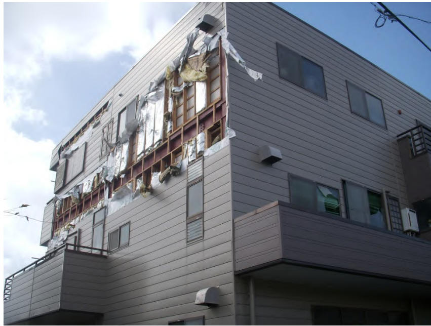
DOD=5 屋根の軒先又は屋根の野地板の破損又は飛散、外壁材の変形・浮き上がり 写真提供：国立研究開発法人建築研究所
