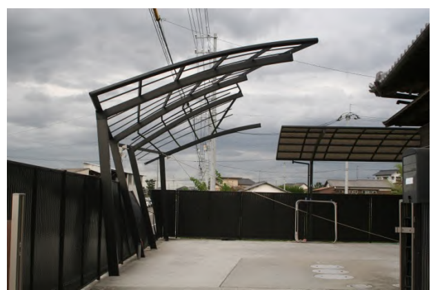
DOD=2 骨組の傾斜 (壁なし・3本柱の片側支持型カーポートのため上限値を採用する事例) 写真提供：徳島大学大学院ソシオテクノサイエンス研究部
