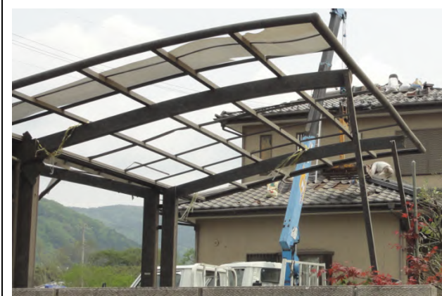
DOD=1 屋根パネルの破損 写真提供：東京工芸大学風工学研究センター
